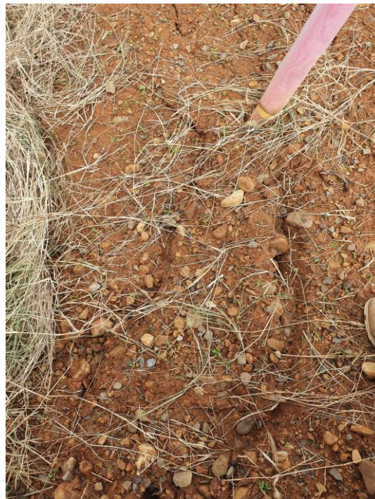
(d)坡面張力裂縫
