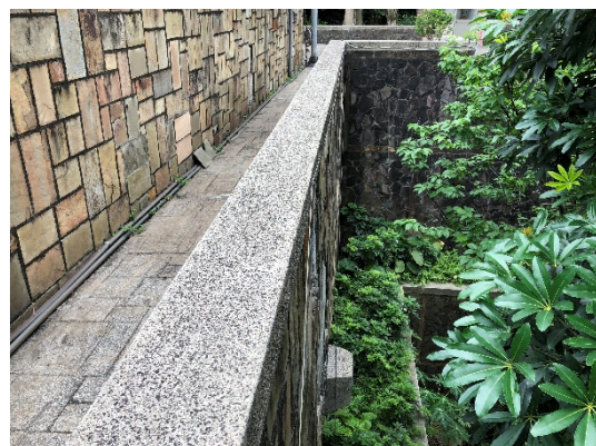
(6)觀星台北社區地錨擋土牆
