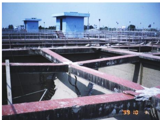
圖2-3 九二一地震豐原第一淨水場沉澱池損害(台灣自來水公司，2000)
