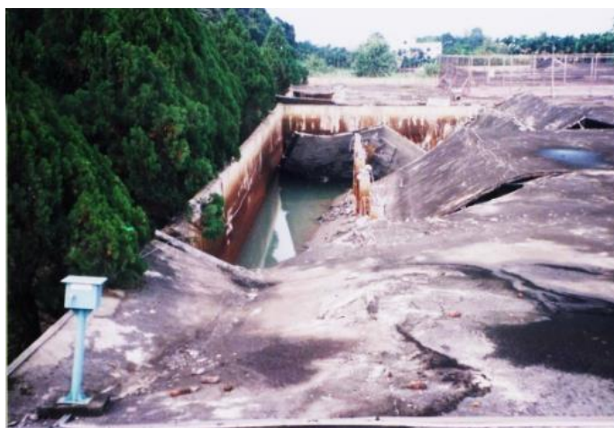
圖2-4 九二一地震豐原第一淨水場清水池損害(台灣自來水公司，2000)
