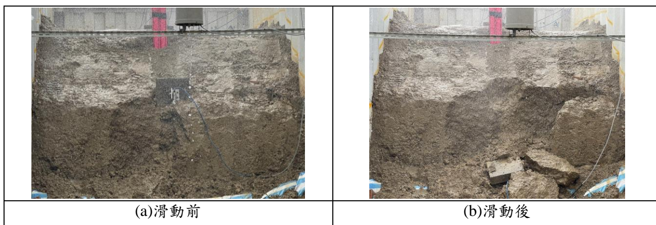
圖 9 邊坡滑動前後正視照片
