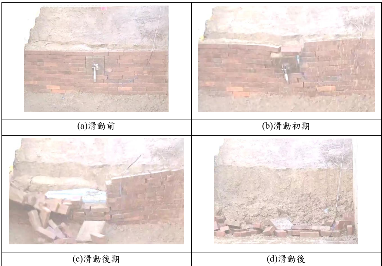
圖 11 邊坡滑動前後正視照片
