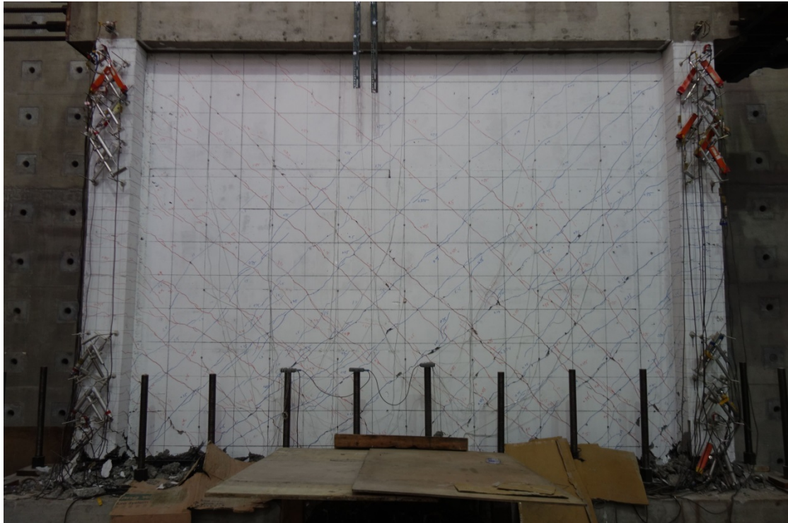
圖 1 試體 1 最終破壞情形
