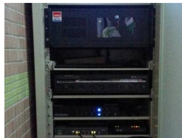
圖 4.2 後端連動控制設備照片
