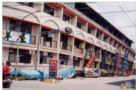
街屋震害照片
