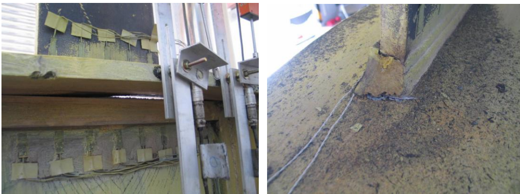
圖 8 ESW 試體柱板受拉拱起破壞
