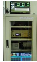
強震即時警報主機
