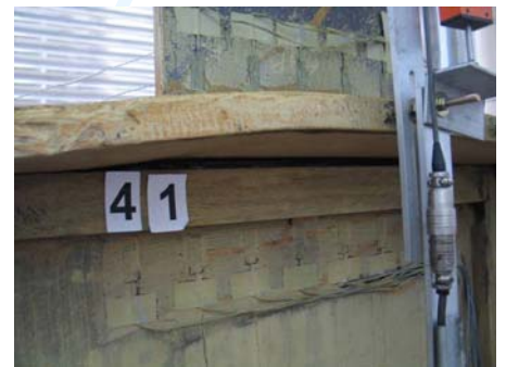
ESW元件試體之破壞情況
