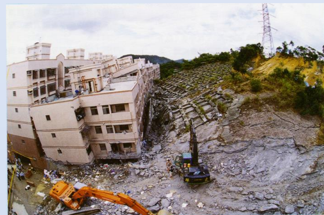
86年8月18日溫妮颱風造成林肯大郡社區擋土牆崩落
