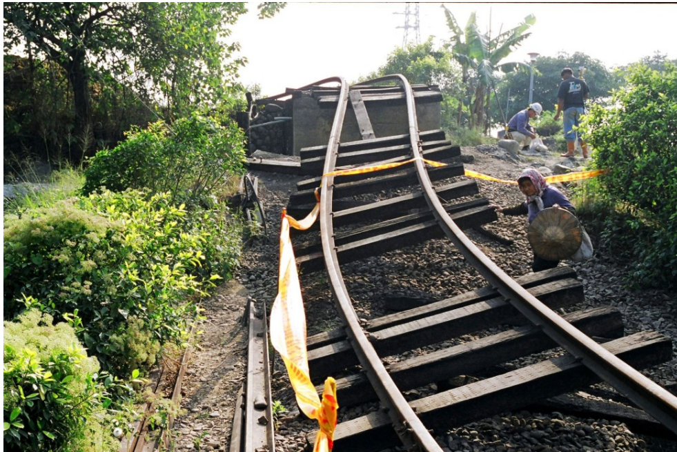
圖 34、集集鐵路線鐵軌隆起變形
