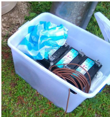
(d) 電池置物箱放置三顆 12V 鉛蓄電池及儀器訊號線組
