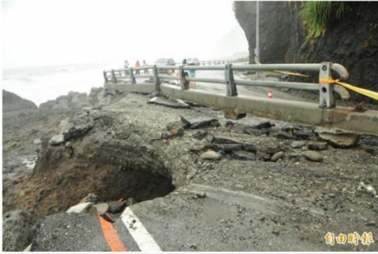
台11線「人定勝天碑」路段剛好是突出海面的岬角彎道，被大浪淘空路基。(記者花孟環攝)
