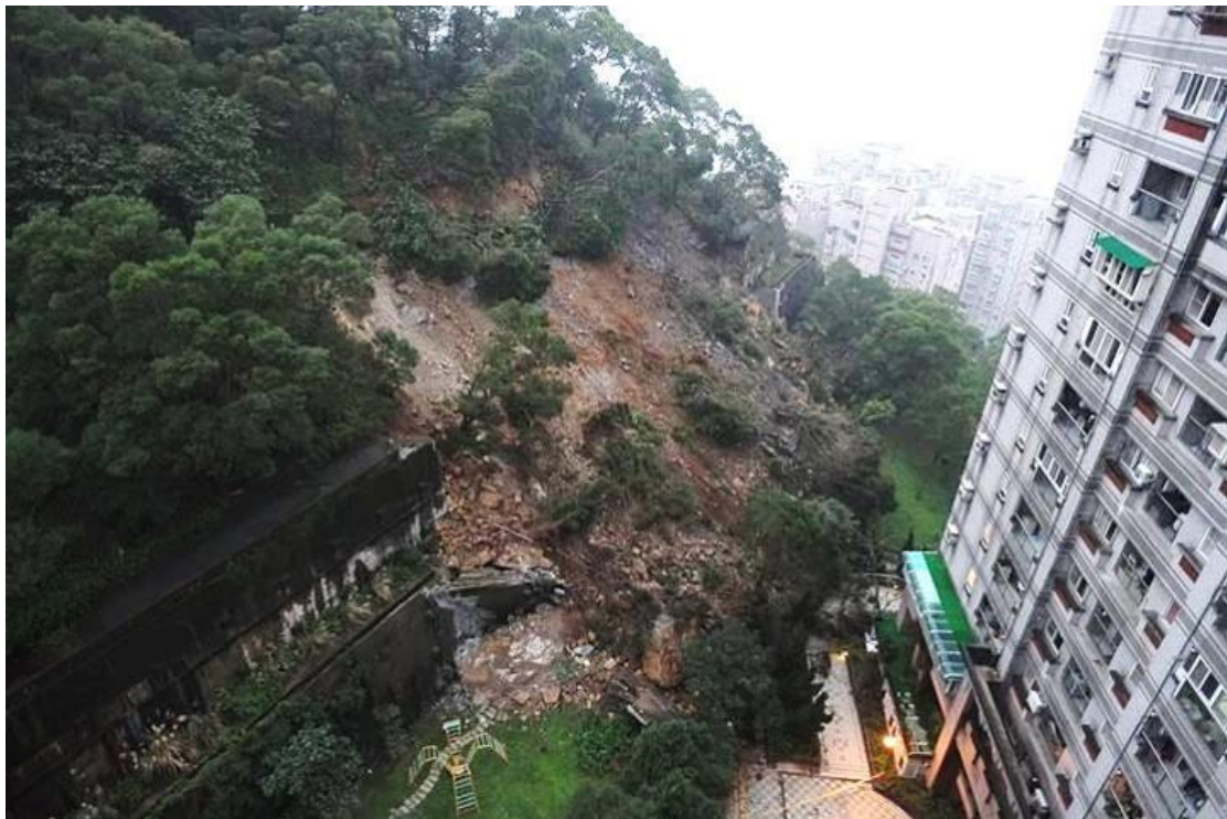
圖 2.1-1 某社區擋土牆崩塌
