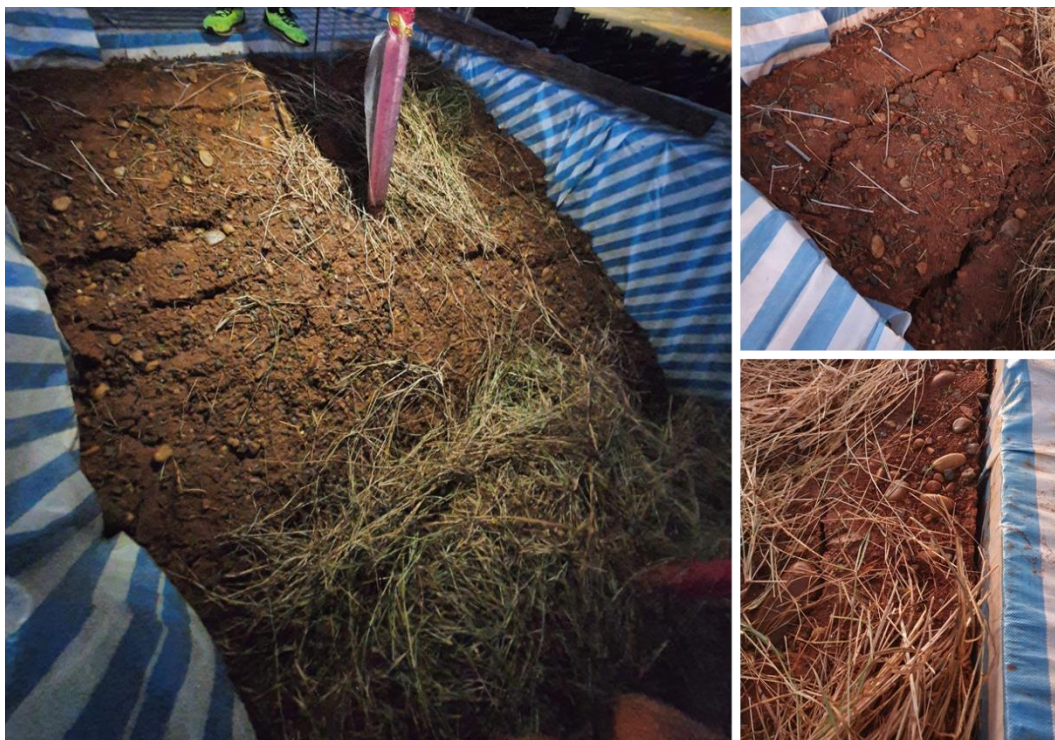
圖 4.3-3 草皮下方裂縫發展情形
