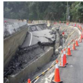
莫拉克颱風期間道路下邊坡崩塌(青山工程顧問公司)
