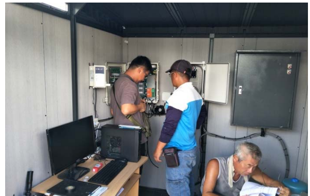
控制系統安裝於機房
