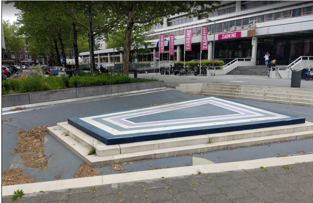
圖2-4-4 水盆底部及排水溝堆積沙跟垃圾 4
