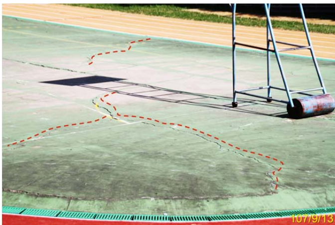
(a)廬山國小操場地坪開裂
