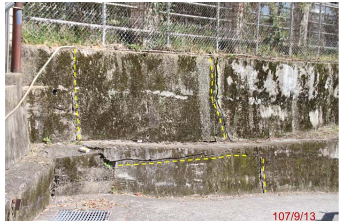
(b)廬山國小擋土結構物開裂
