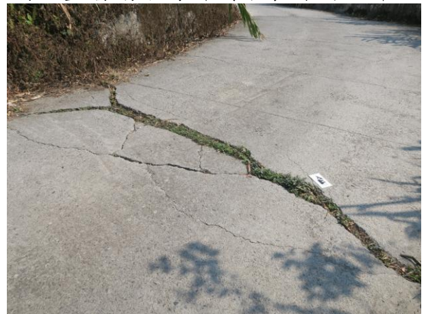
照片 13.場址內近期崩塌所引致的人工構造物開裂
