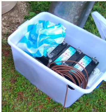
(e) 電池置物箱放置三顆 12V 鉛蓄電池及儀器訊號線組
