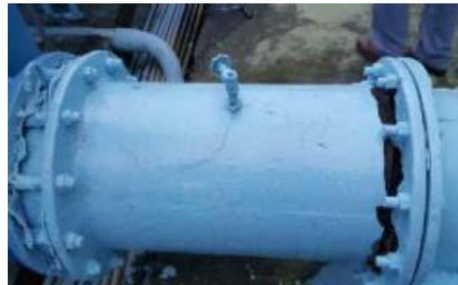
(b)潭頂場內抽水機出水管扯裂
