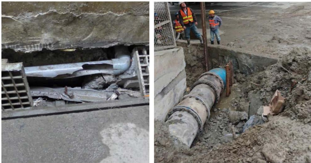
圖 7、管線因液化沉陷破壞、輸水鋼管因路堤液化導致接頭破壞
