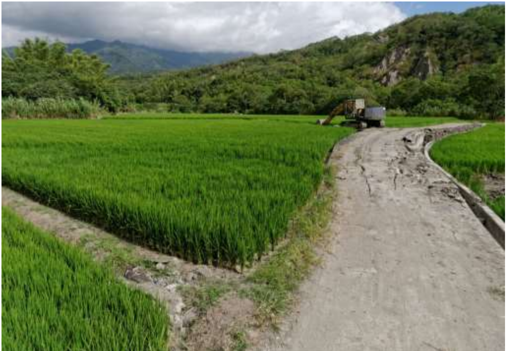
圖 9、富里鄉南側，富池橋附近稻田中，池上斷層活動引致地表破裂，向東南拍攝。
