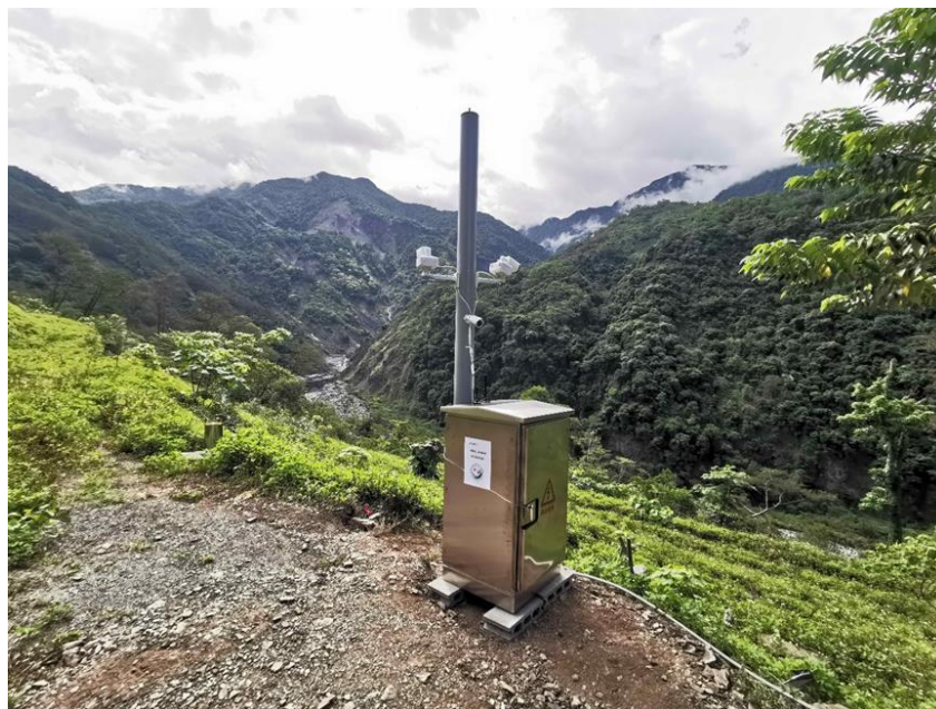
圖 2.6 現場攝影機，雨量計還有地聲檢知器，配以中控小屋
