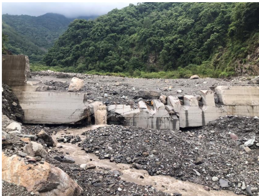
圖 2.12 離下游 1.3 公里處的第二座壩已經毀壞，壩基掏空
