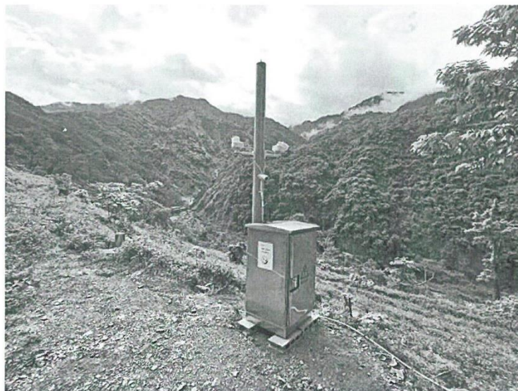
圖 3 現地土石流觀測系統及儀器架設現況
