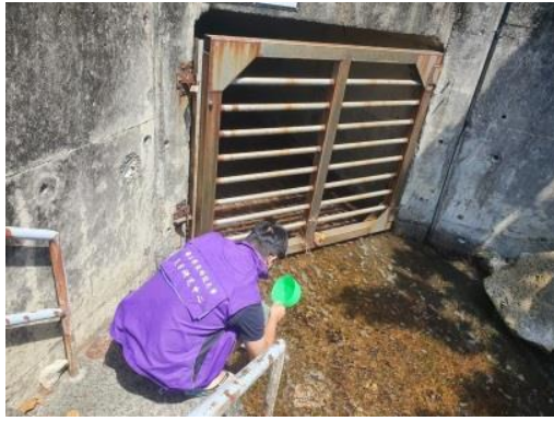
(i)雨水渠道口-排放水
