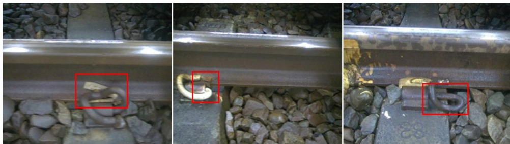
圖 4.29 軌道 e 扣夾缺失與位移
