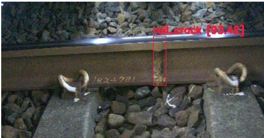
圖 4.42 現地驗證誤判情形—鐵軌銲接處誤判為鋼軌裂縫
