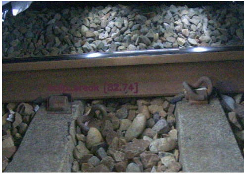
圖 4.39 第三階段臺中現地驗證檢出紀錄—e 扣夾缺失(續)
