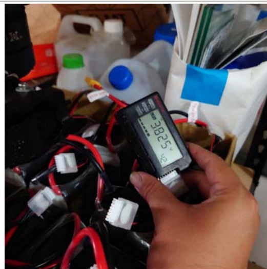
電池外觀 & 電池電壓
