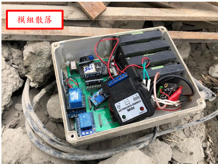
圖 6.45 南市道 175 線 25.5k 場址 ID3 監測模組遭人為破壞
