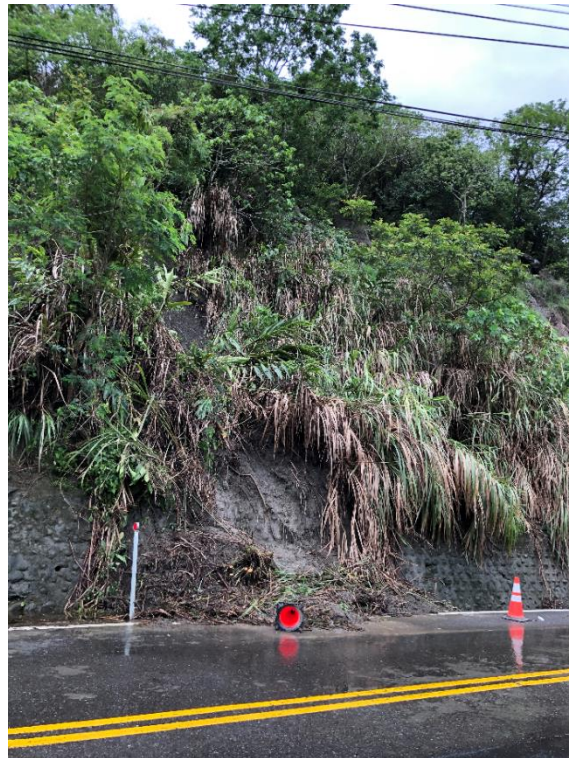
圖 4.23 台 20 線鄰近 50.7k 邊坡未改善區域崩塌現象
