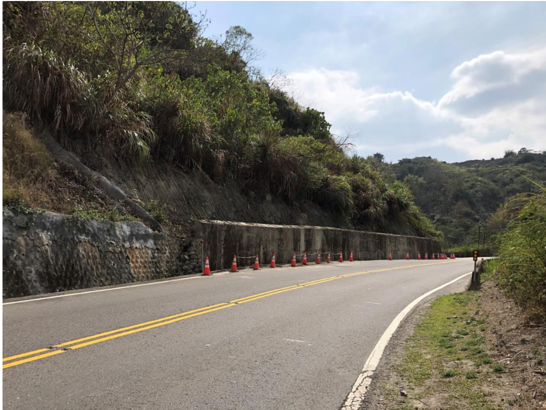
圖 4.11 台 20 線 50.7k 邊坡 110 年 4 月地貌(1/2)
