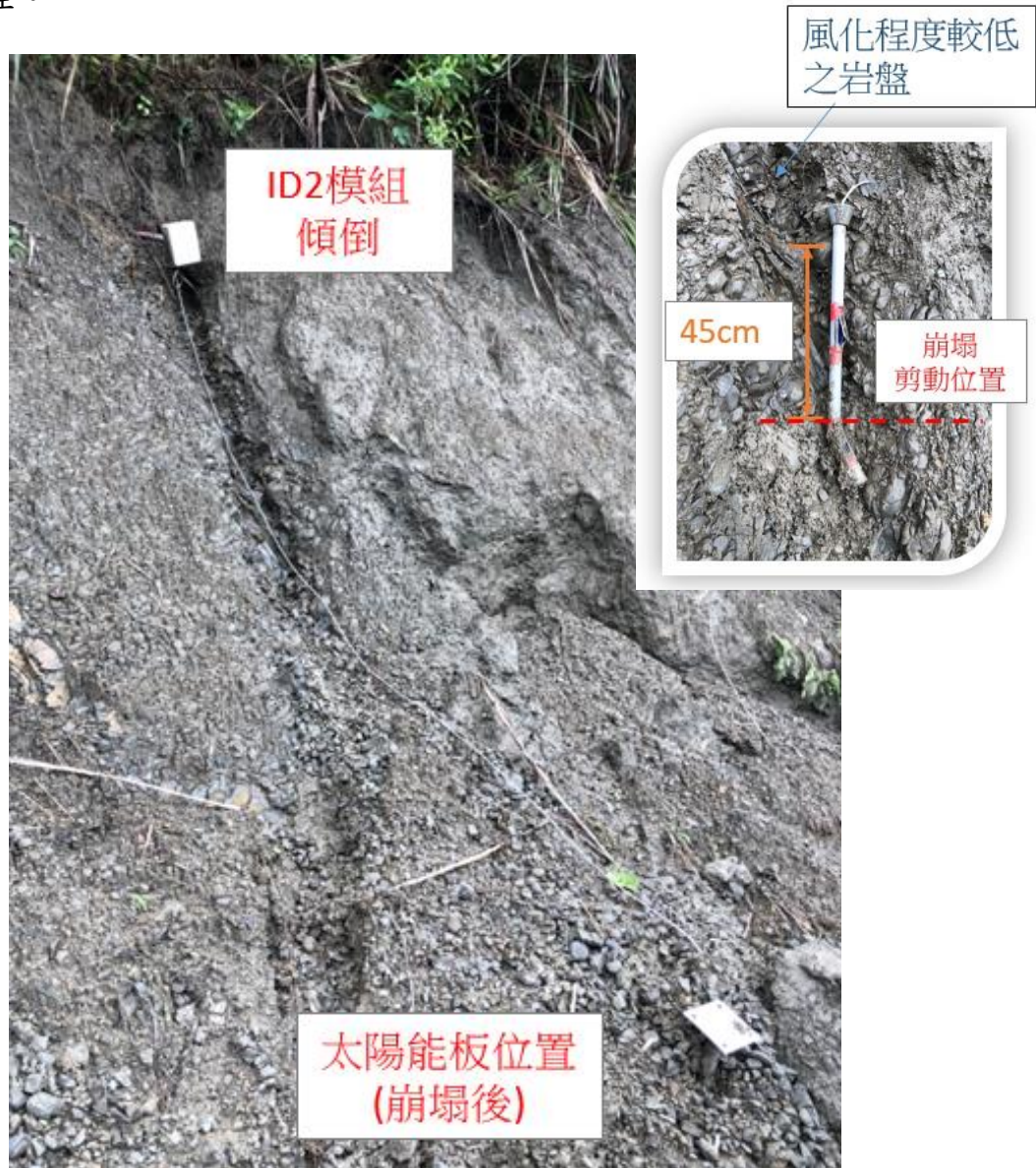
圖 4.25 台 20 線 50.7k ID2 模組崩塌後狀況
