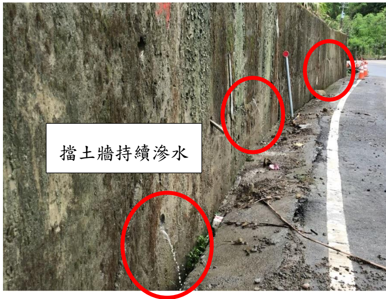
圖 4.24 台 20 線 50.7k 原傾倒重力式擋土牆滲水狀況
