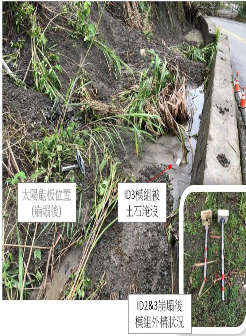
圖 4.26 台 20 線 50.7k ID3 模組崩塌後狀況
