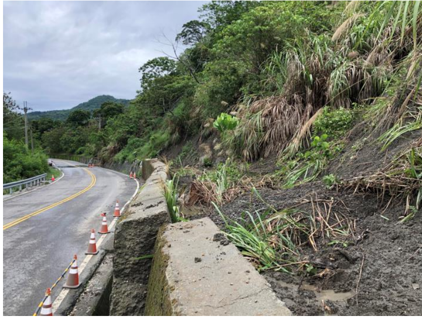
圖 4.22 台 20 線 50.7k 邊坡 6/7 邊坡現況(6/5 發生崩塌)
