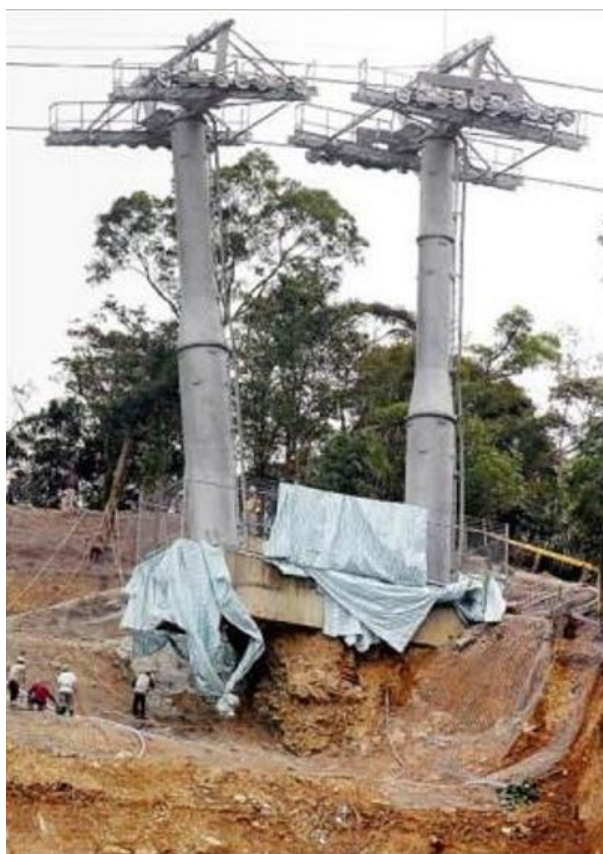
圖 4-3 塔柱災後局部邊坡破壞(林冠良 2015)
