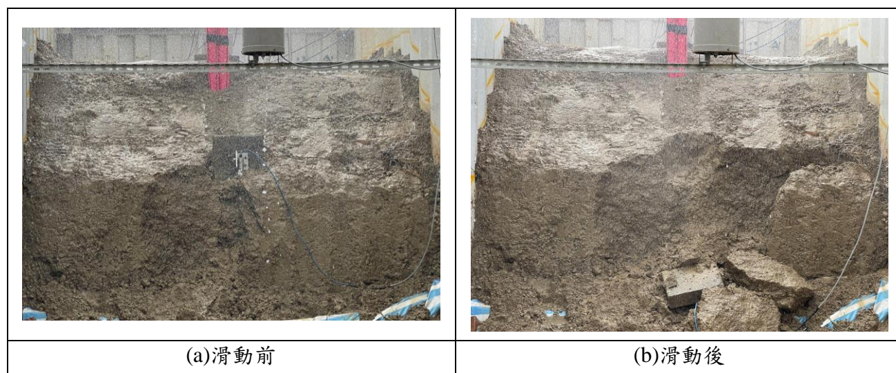
圖 3-31 邊坡滑動前後正視照片
