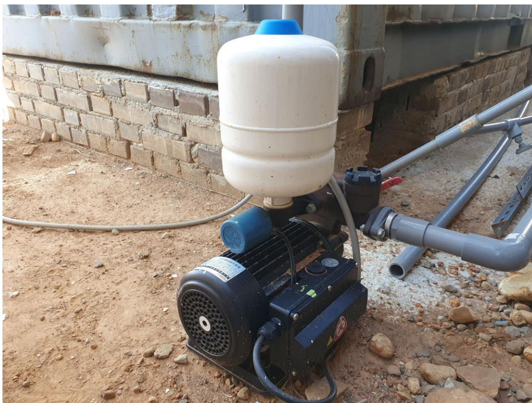
圖 3-14 人工降雨裝置供水之加壓馬達
