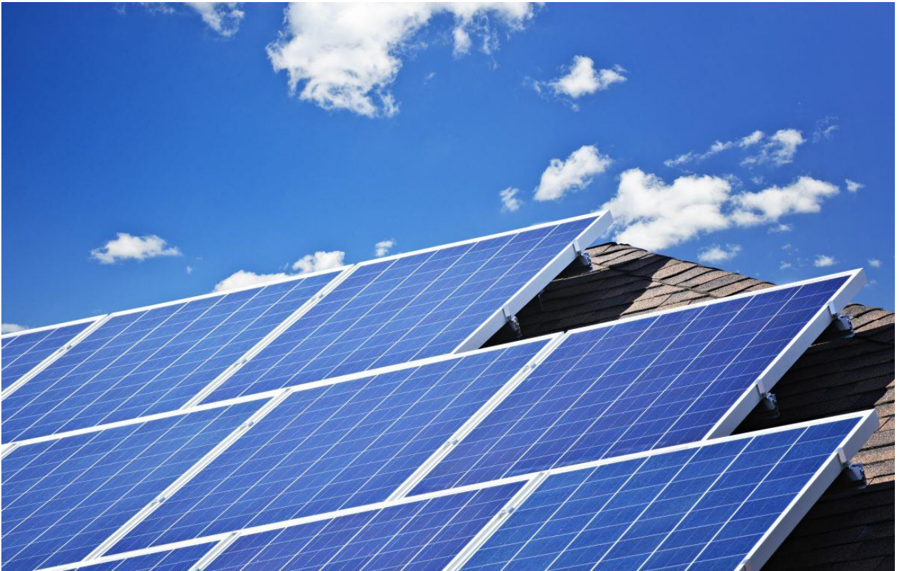
圖 2-26 太陽光電發電示意照片
