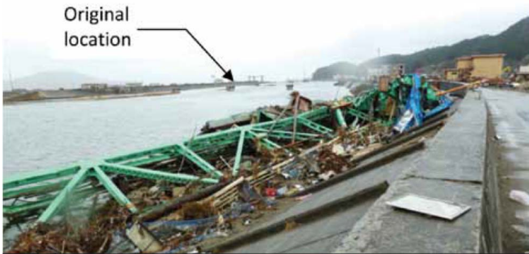
圖 6.34 東日本 311 海嘯致使橋梁拖離橋墩 (資料來源：Chock, 2013)
