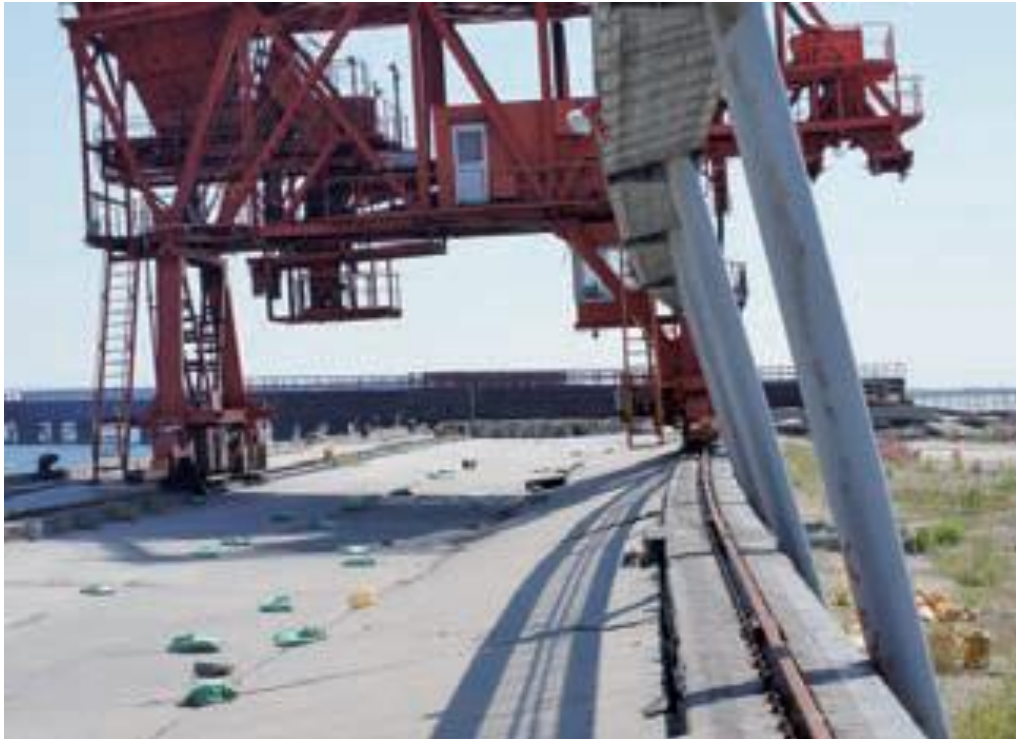
圖 1.5 東日本大地震(機械設備軌道彎曲變形)
