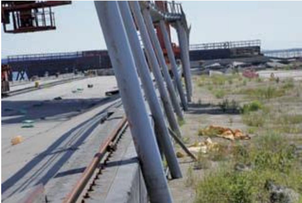
圖 1.3 東日本大地震(後側地盤差異沉陷)
