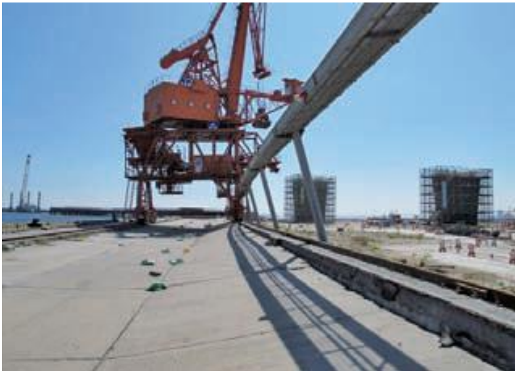
圖 1.2 東日本大地震(陸海側軌道間岸間下陷)
