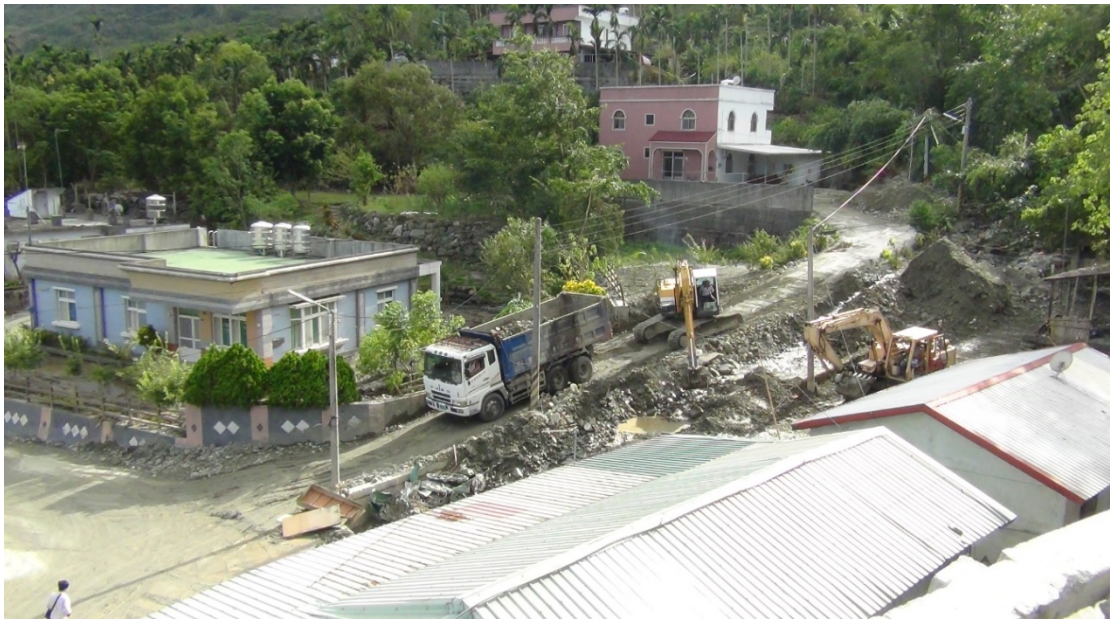
圖 3-5 瑞北村土石流側拍
