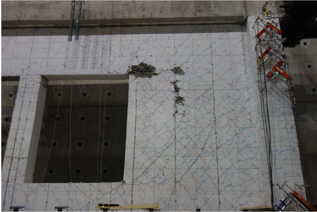
圖 4- 90 窗右上角(壓桿承壓區)保護層剝落
