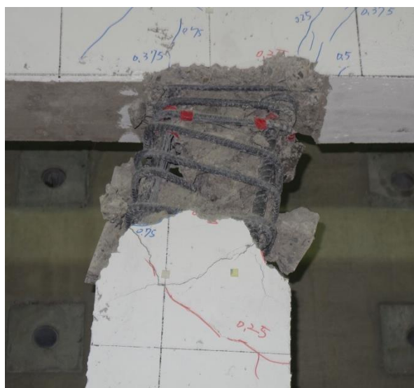
圖 4- 118 門及窗間之小柱塑鉸區破壞情形
