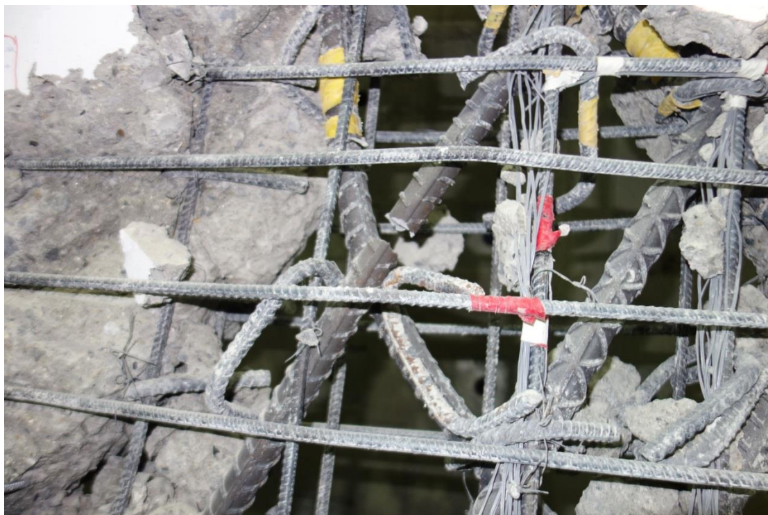
圖 4- 117 第二支對角向鋼筋拉斷
