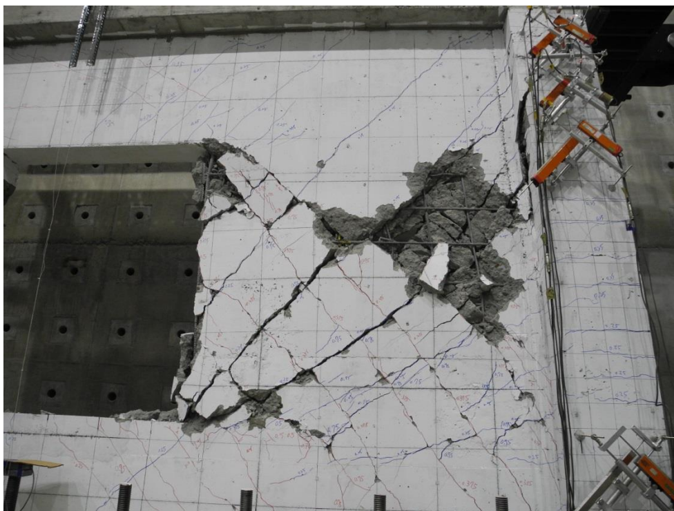
圖 4- 56 牆體正負向壓桿交會區嚴重剝落
