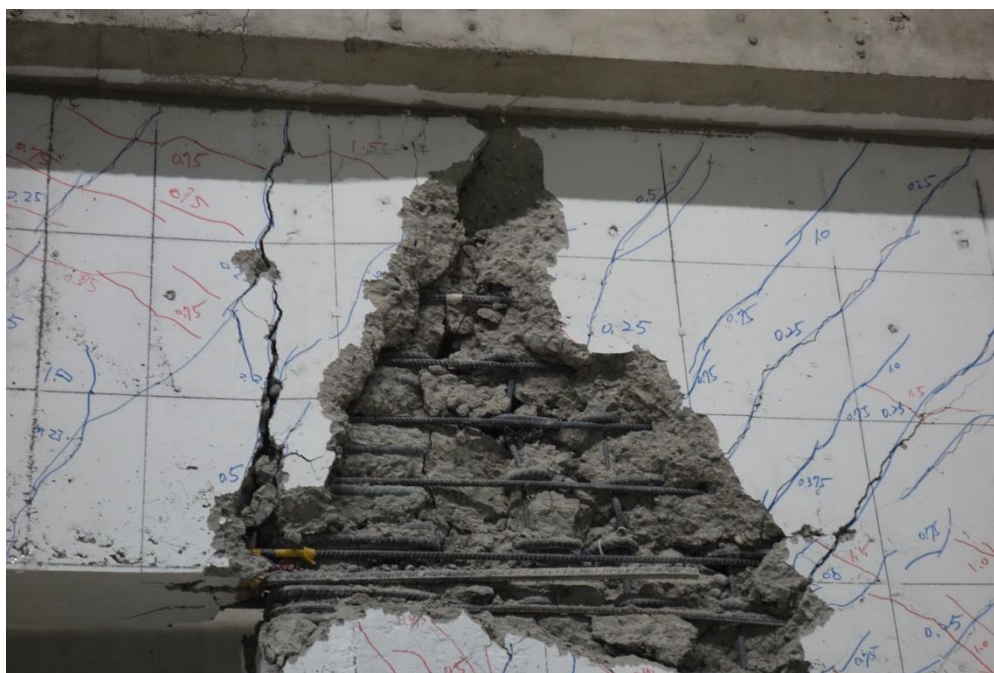
圖 4- 102 壓桿承壓區破壞往上擴展
