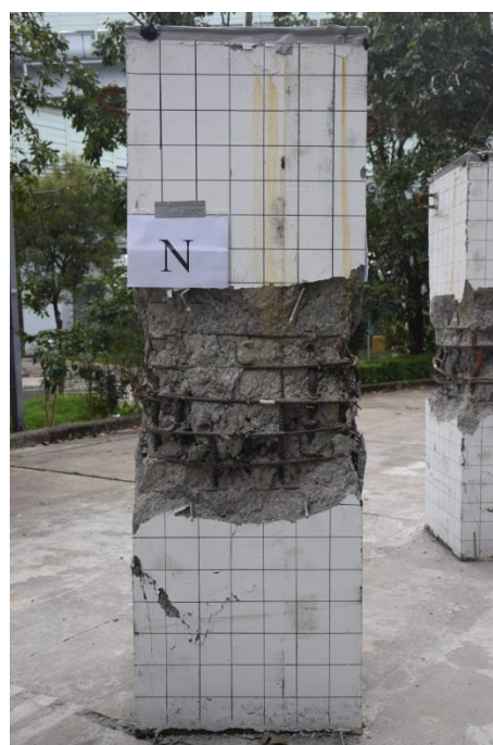
照片 4. 56 T5-2 試體破壞後-N 面
