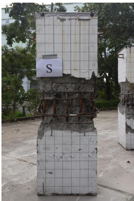
照片 4. 31 T2-2 試體破壞後-S 面
