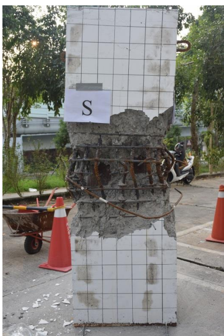
照片 4. 35 T3-1 試體破壞後-S 面
