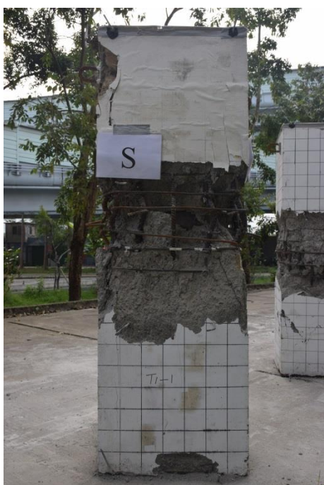
照片 4. 19 T1-1 試體破壞後-S 面
