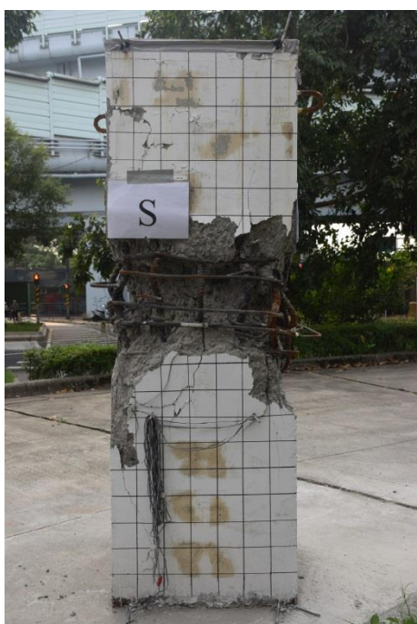
照片 4.27 T2-1 試體破壞後-S 面
