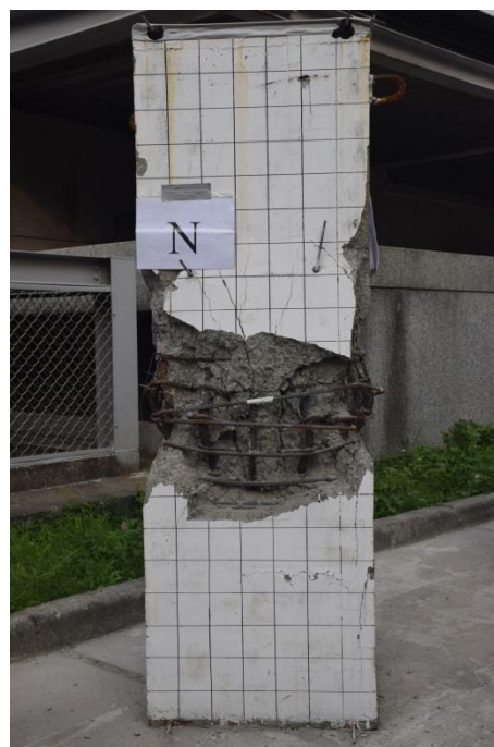
照片 4. 32 T2-2 試體破壞後-N 面
