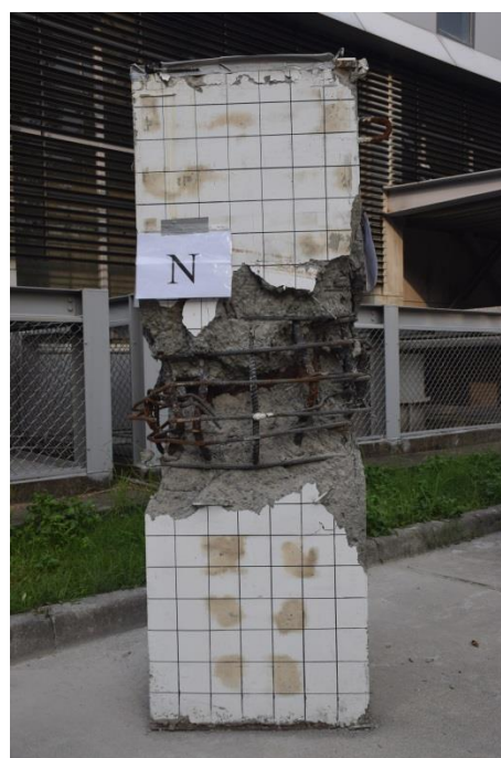
照片 4.28 T2-1 試體破壞後-N 面
