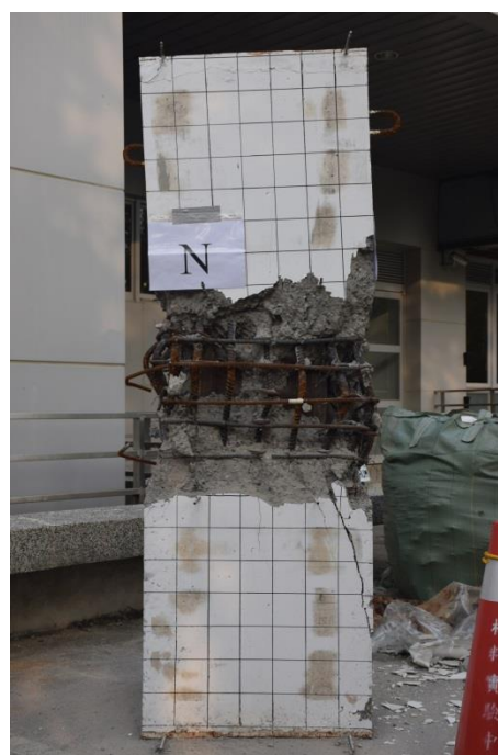
照片 4. 36 T3-1 試體破壞後-N 面
