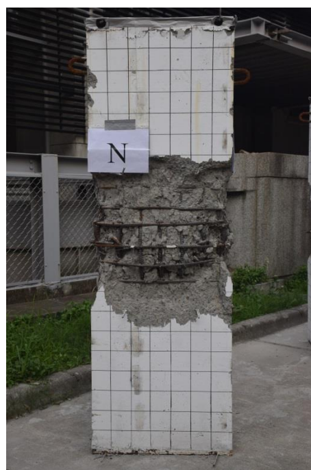
照片 4. 52 T5-1 試體破壞後-N 面
