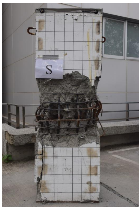
照片 4. 39 T3-2 試體破壞後-S 面
