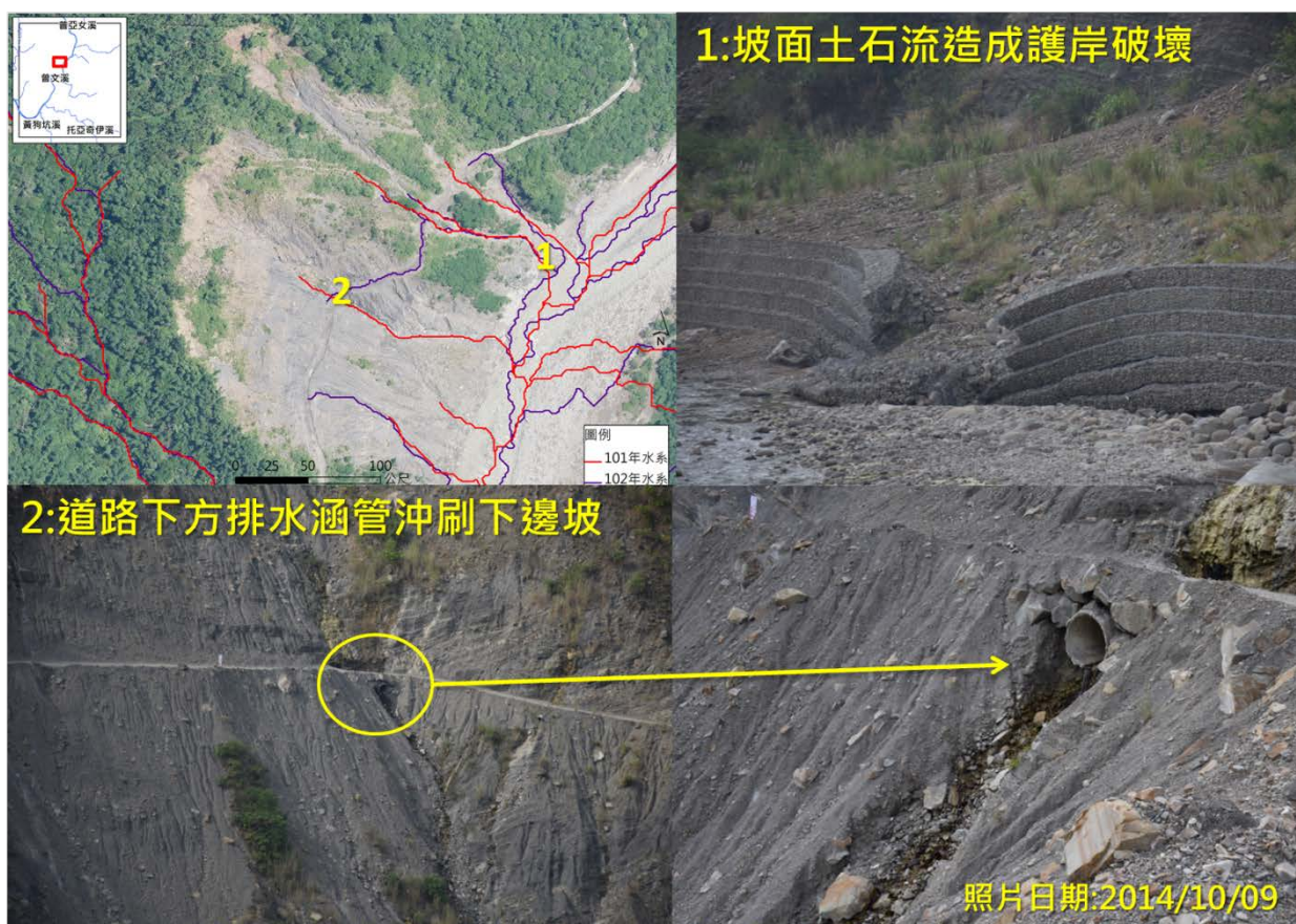
圖 4.57 水系改變導致道路災害位置發生變化實況照片
