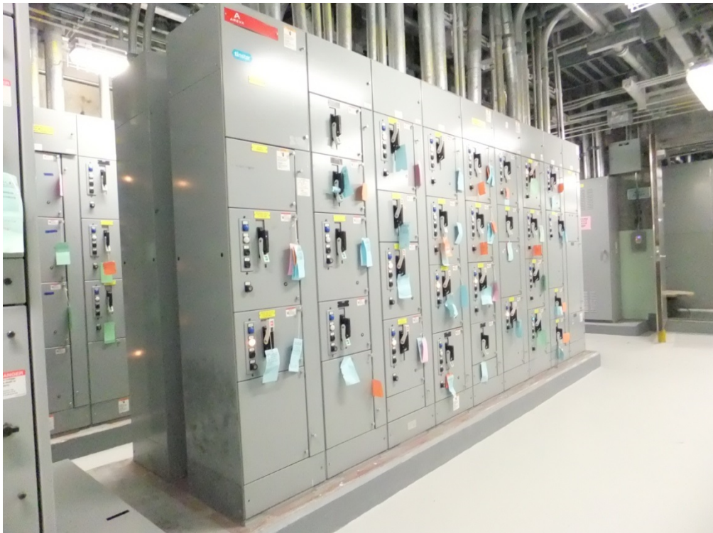
圖 2.2 龍門電廠 MCC 電氣盤體之機櫃
