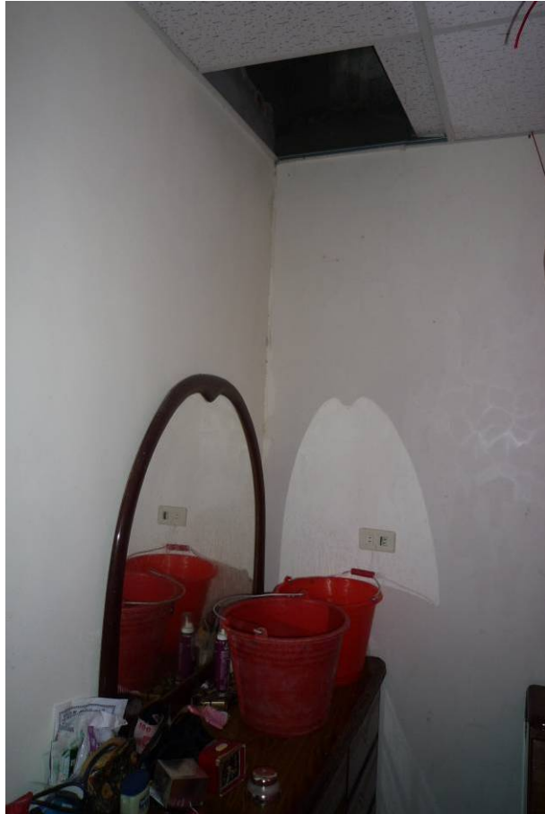
照片5.55 日月潭邊住商樓三樓水管破裂而漏水
