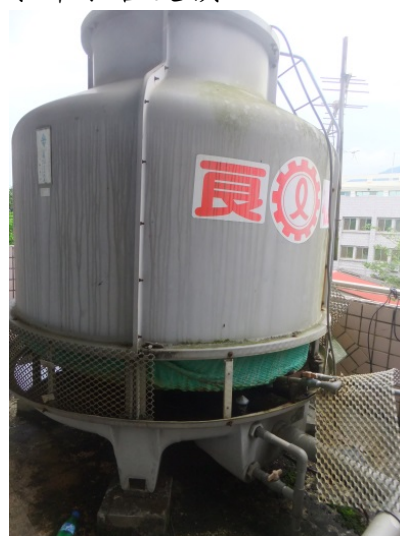
(b) 冷卻水塔
