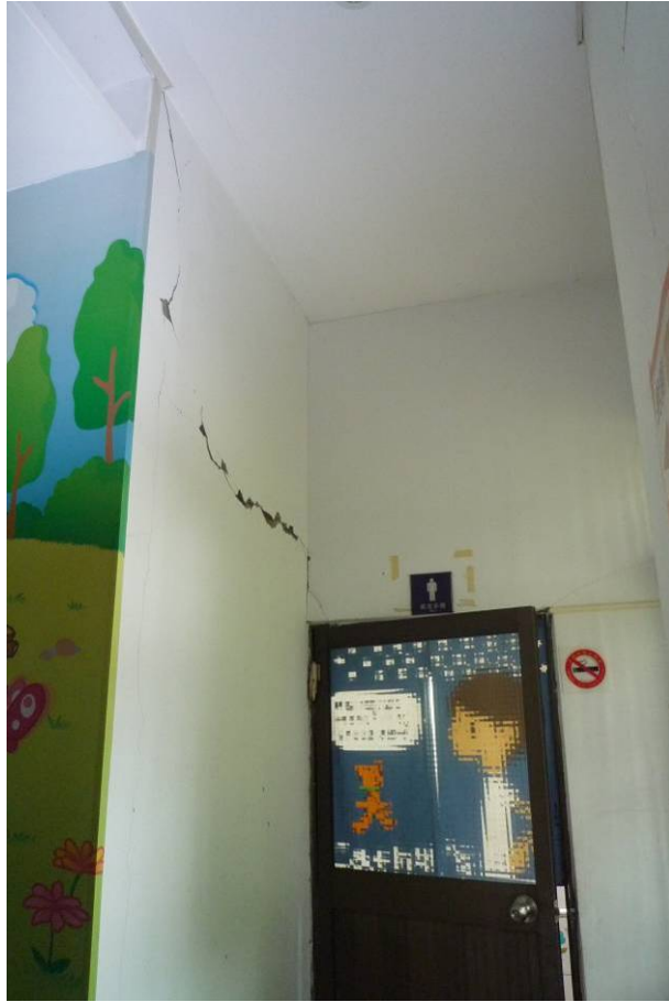
照片5.36 一樓男廁之隔間磚牆產生剪力裂縫
