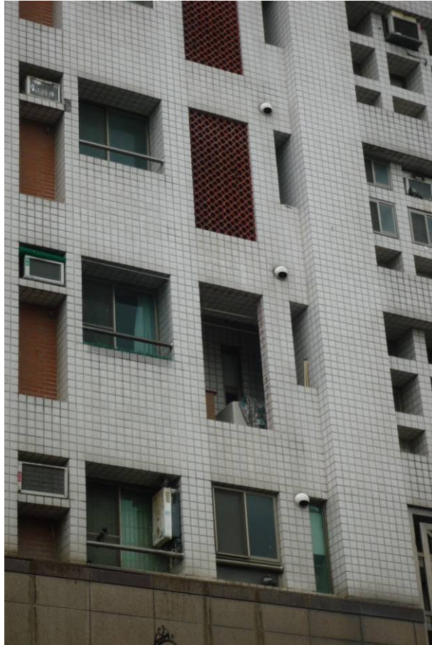
照片5.13 斗六住商2大樓正面4樓，整片磁磚牆掉落
