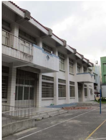
圖 6.21 活動中心外牆磁磚掉落
