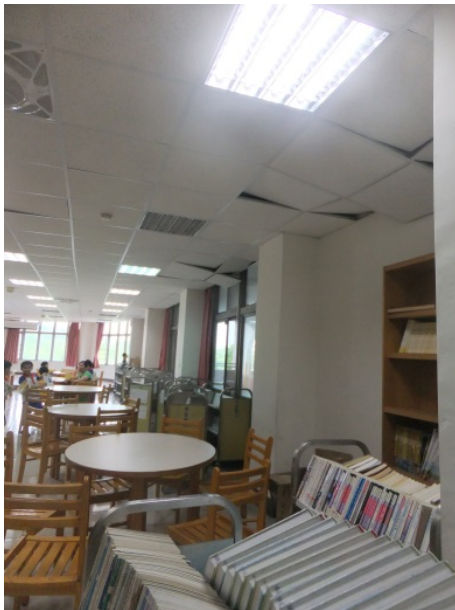
(a) 破壞照片 1
