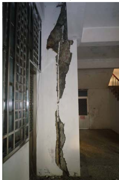
(b)柱體裂縫更加嚴重 (0602 南投地震)
