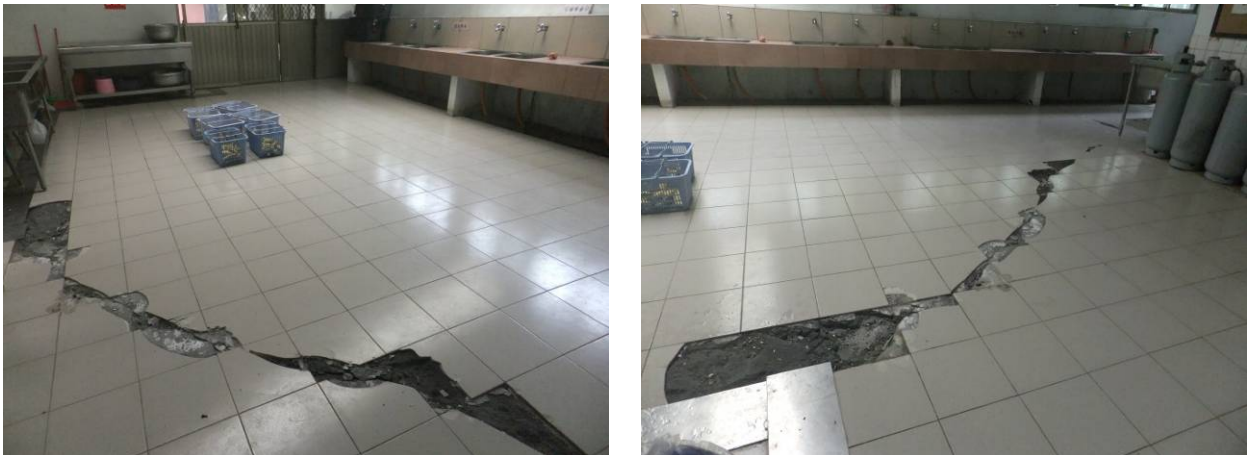
圖7.53 廚房地板磁磚破裂
