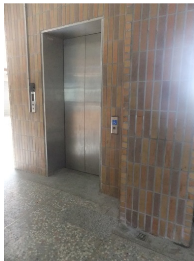
圖7.67 綜合實習工廠大樓電梯受損
