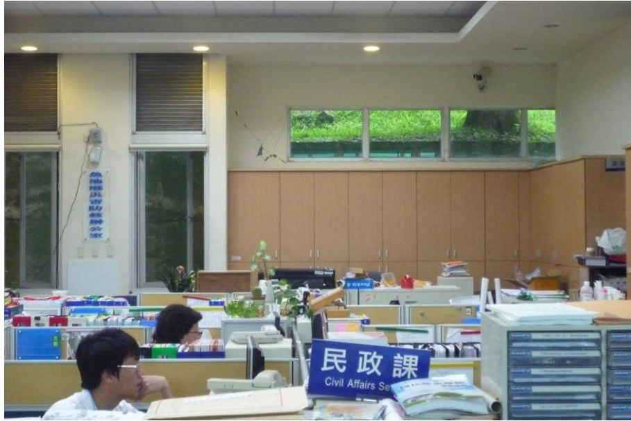
照片5.52 一樓RC外牆開高窗兩側剪力開裂(室內)
