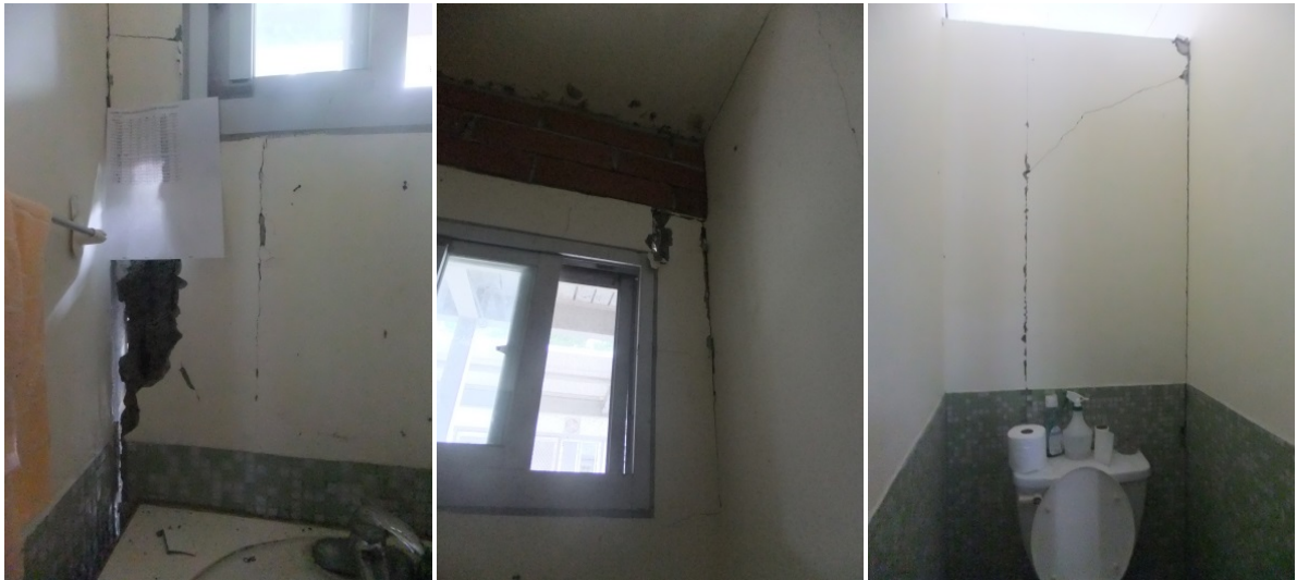
圖 6.37 一樓保健中心廁所輕隔間牆裂損
