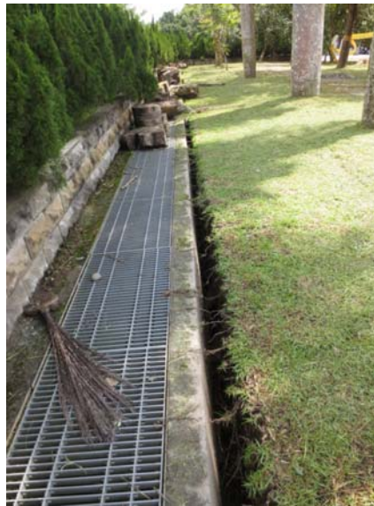
圖 6.4 擋土牆與牆背土體間之明顯間隙
