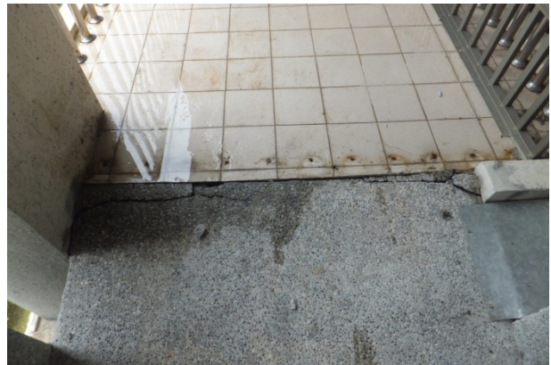
圖 6.47 學生宿舍隔離縫處鋪面破損
