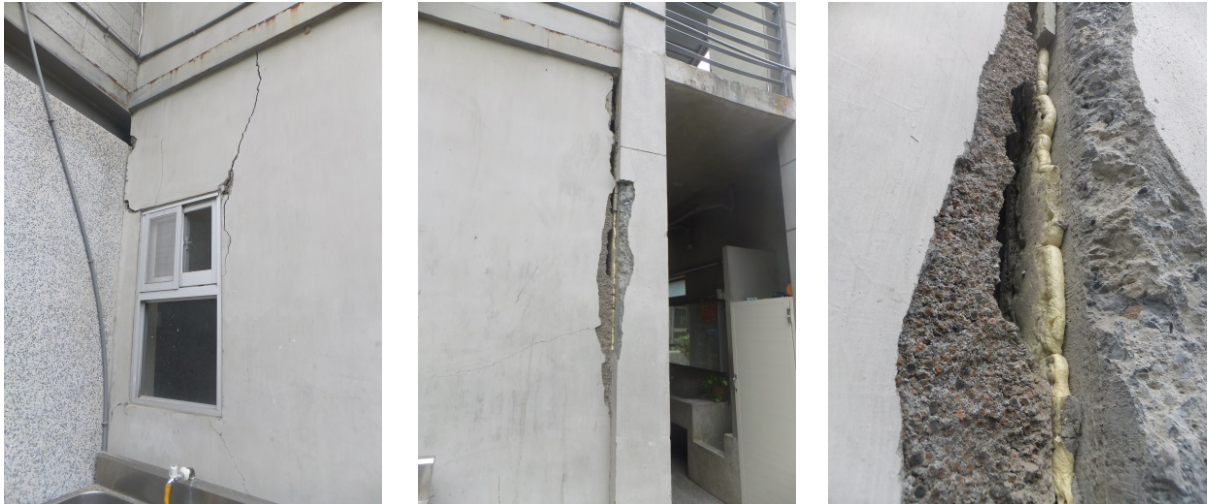
圖7.44 一樓男廁鋼骨柱間穿透性裂損剝落
