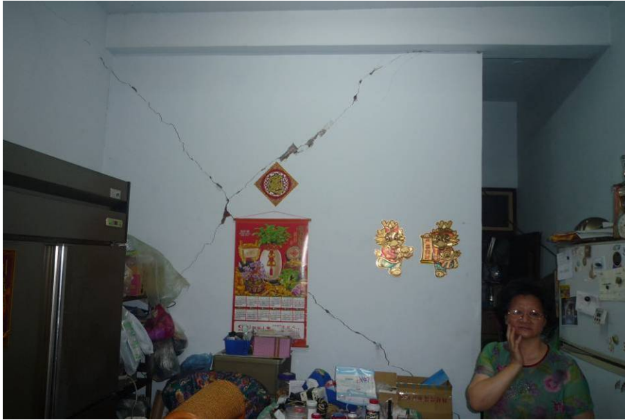
照片5.19 與街道平行的隔間牆大多有出現剪力裂縫
