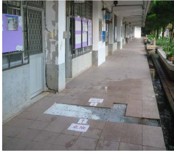
圖 6.28 教學大樓之走廊地板產生隆起破壞
