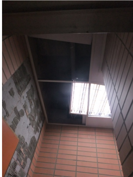
圖7.84 一樓廁所磁磚掉落
