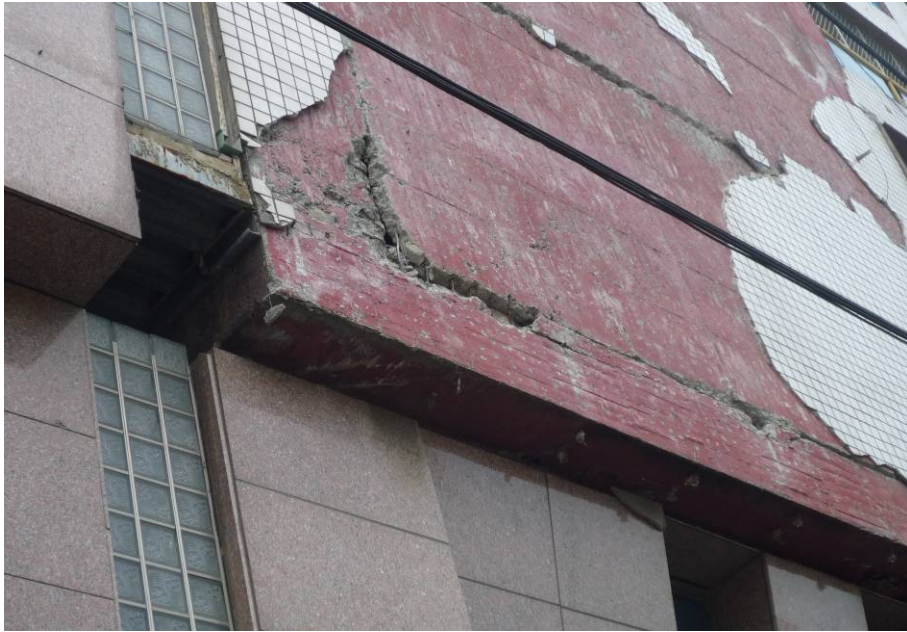
照片 5.8 斗六住商 1 大樓正面損壞情況(局部照片)
