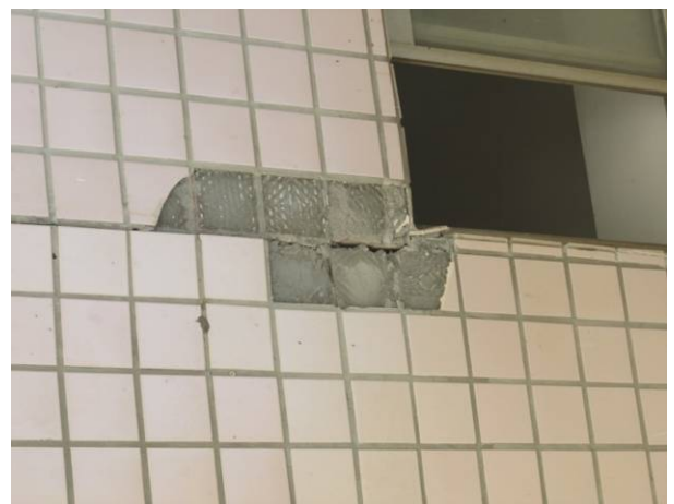
(b) 體育館男廁外牆磁磚掉落
