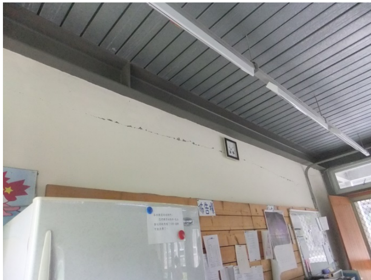
圖7.46 一樓導師室與穿堂間的水泥牆水平裂縫
