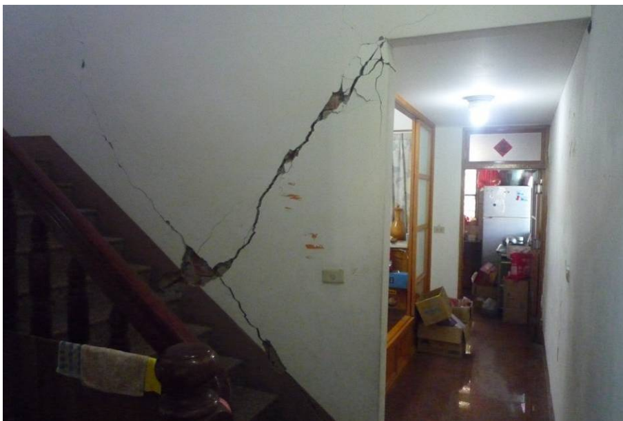
照片5.30 樓梯間兩旁的隔間牆（與街道平行）出現剪力裂縫
