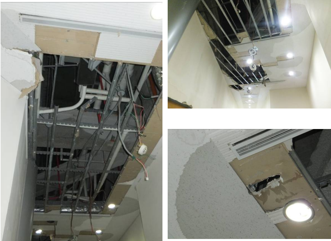
圖7.5 九樓 A 處暗架式天花板破損
