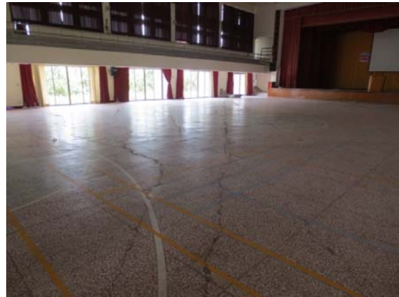
(d)地板出現裂縫
