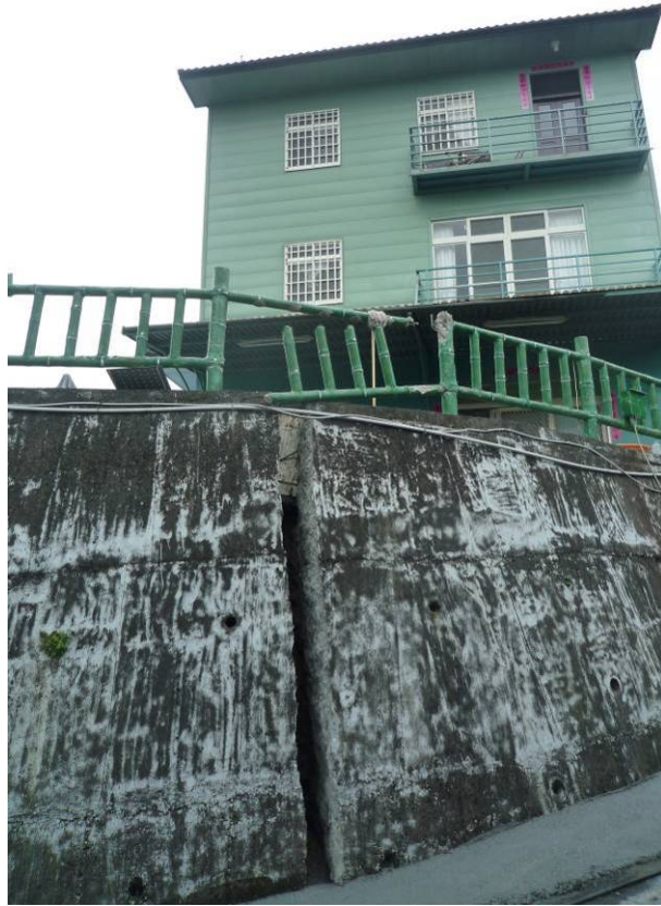
照片5.49 擋土牆之間連結處產生嚴重的滑動大裂縫
