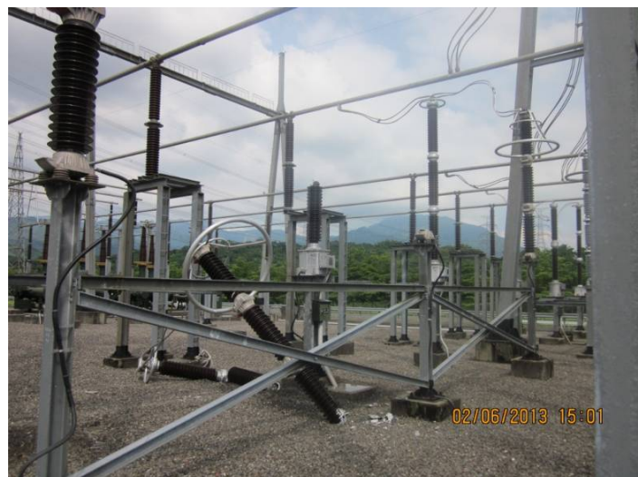
圖7.21 嘉民三路避雷器與比壓器破壞情形(台電提供)
