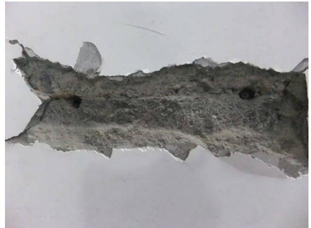
(b) 粉刷層剝落處放大照片
