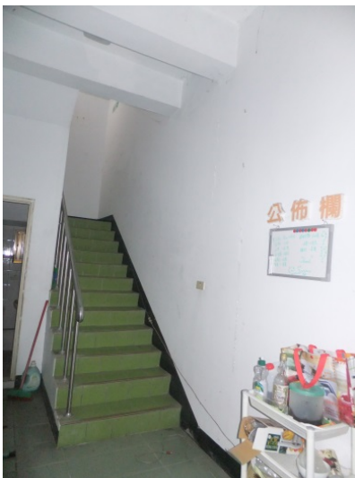
圖 6.46 教師宿舍鋼筋混凝土牆體裂縫
