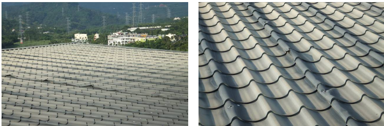
圖7.31 屋頂層部分鋼構屋瓦變形受損
