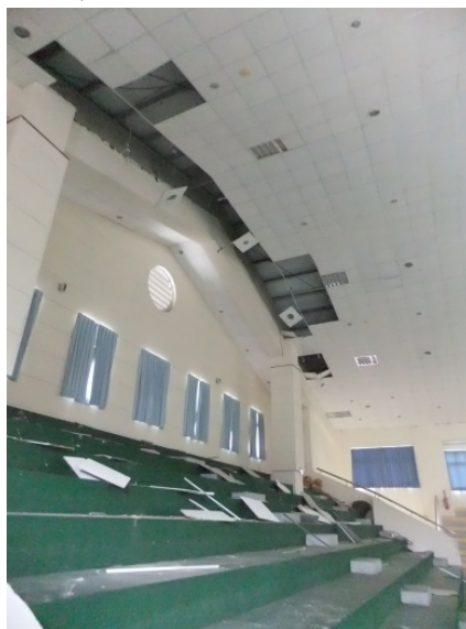
(b)入口處頂部破壞情形
