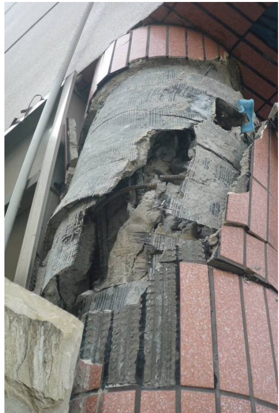
圖 5.28 竹山民宅 2 左側柱產生剪力破壞
