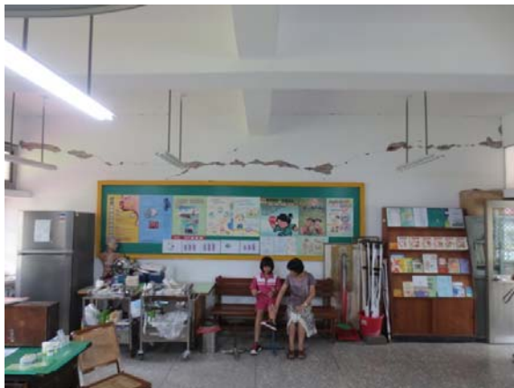
圖 6.71 樂群樓健康中心隔間磚牆承受剪力出現斜剪裂縫
