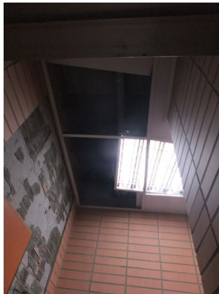
圖 6.62 至真樓一樓廁所磁磚掉落
