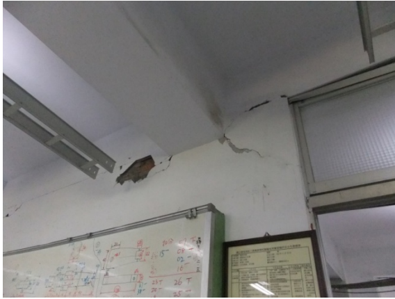
(a)破壞照片 1
