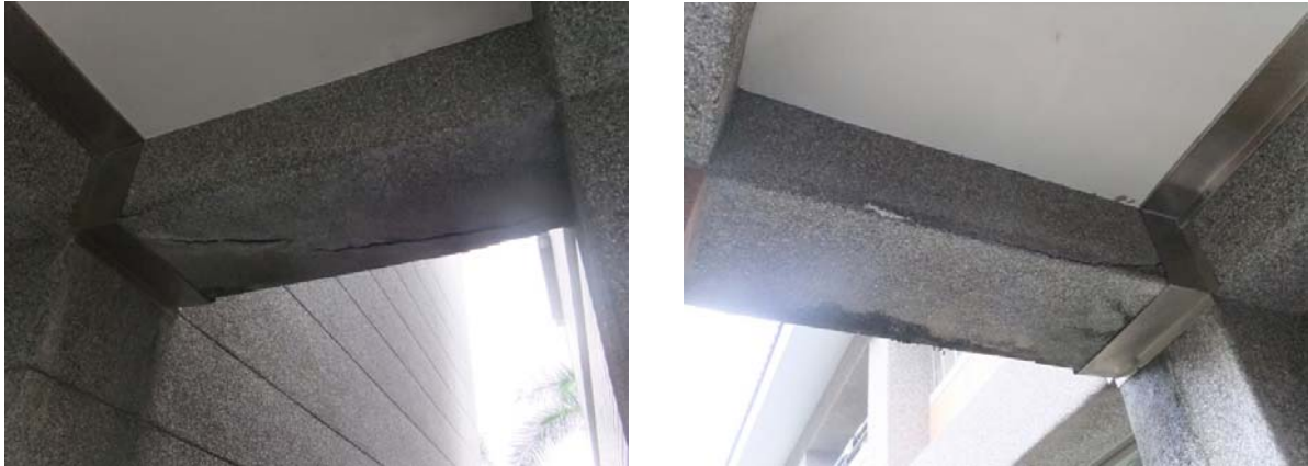
圖 6.61 至真樓與專科教室二樓隔離縫附近梁底鋪面材破損
