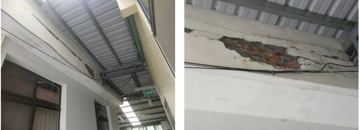
圖7.52 廚房屋頂磚砌女兒牆外粉刷層剝落、水平裂縫
