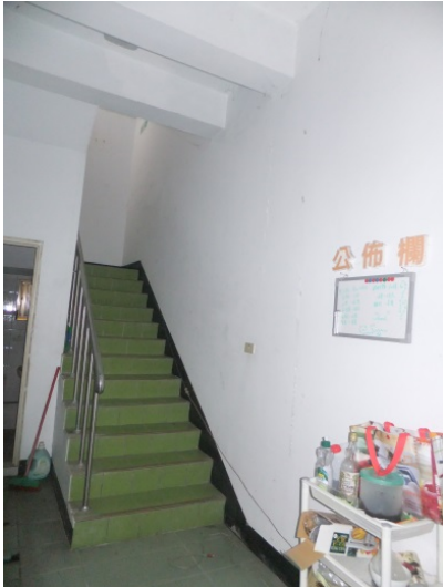
圖7.54 老師宿舍鋼筋混凝土牆體 裂縫
