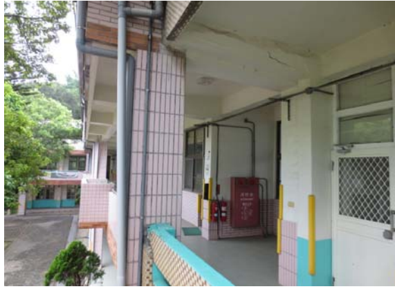
圖 6.76 鄰棟碰撞造成梁體混凝土剝落
