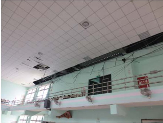
圖 6.10 活動中心門口上方天花板與管線掉落
