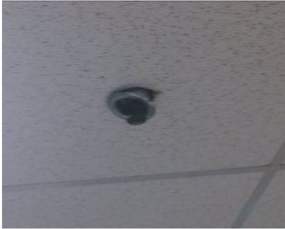
圖7.12 新醫療大樓七樓消防灑水頭蓋板掉落
