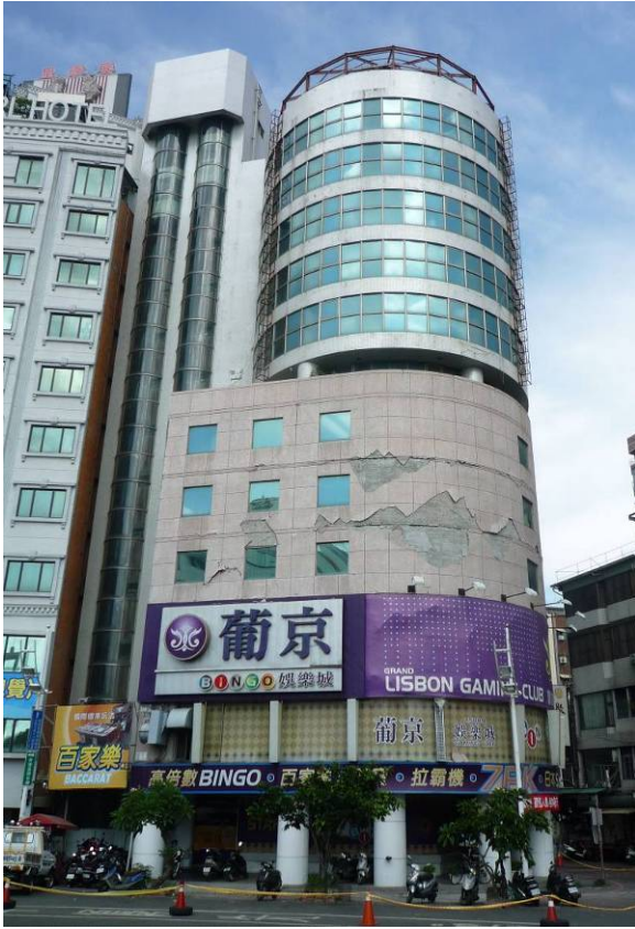
照片5.2 斗六商辦建物於本次地震後外觀實際情況
