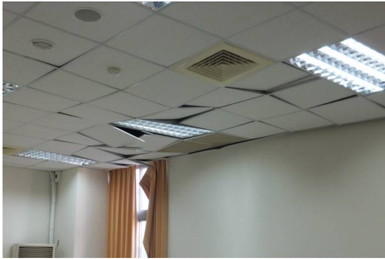
圖7.28 四樓圖書室天花板掉落
