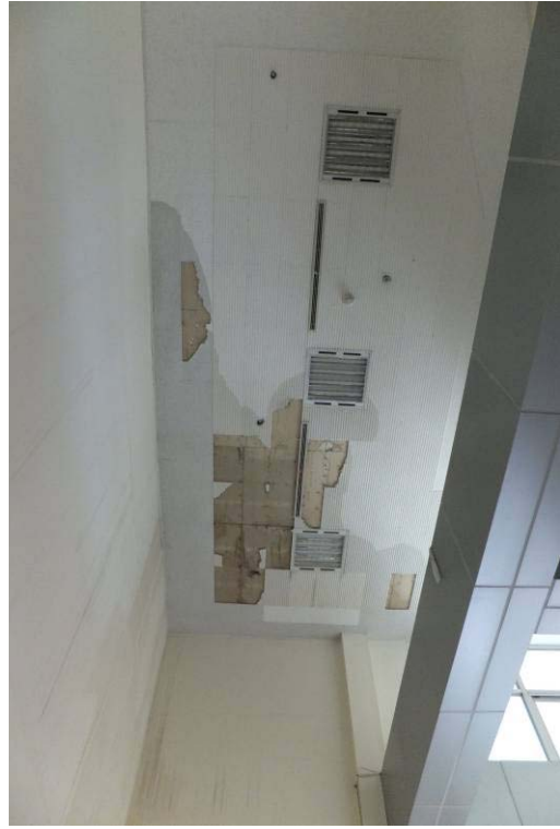
圖7.7 九樓B處天花板系統局部板材脫落
