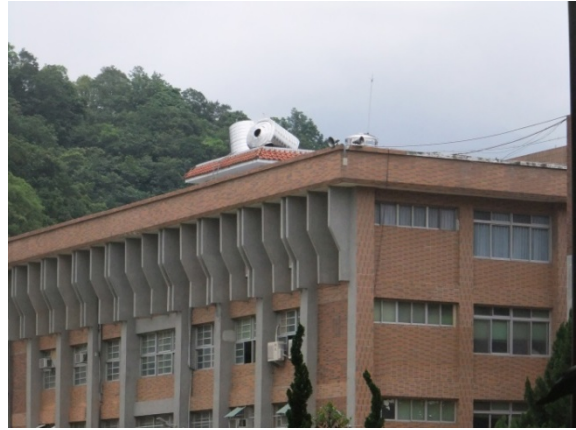
(b)圖書館水塔震損等待置換
