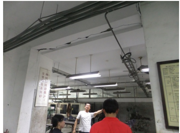
(d)破壞照片 4
