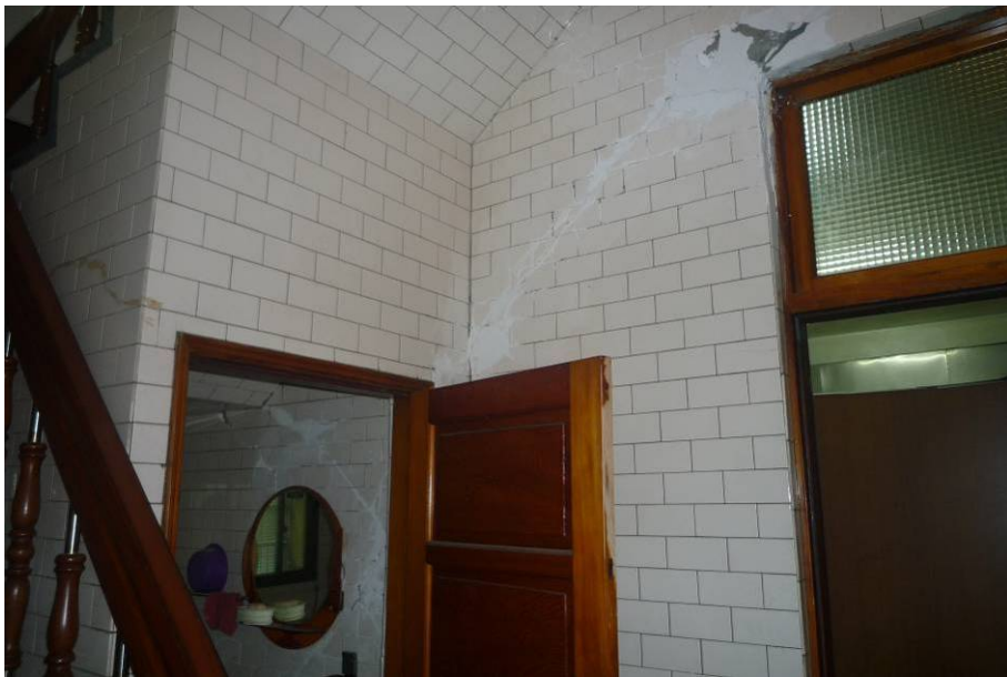
照片5.21 樓梯間兩側的隔間牆產生剪力破壞的裂縫
