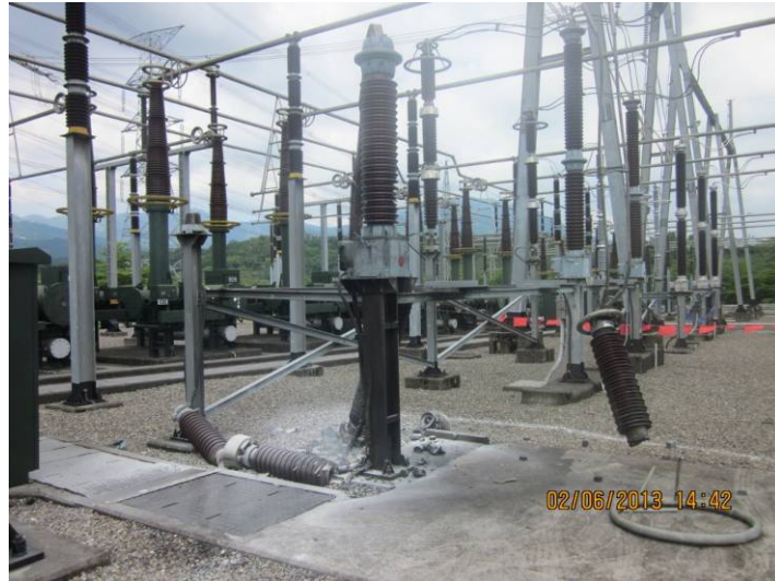
(a) 破壞照片 1
