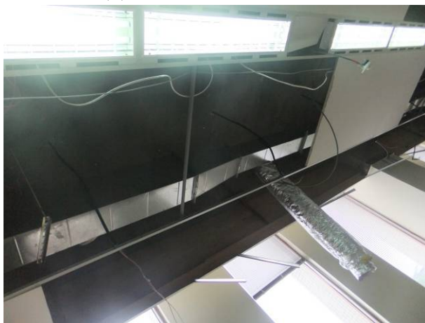
(c) 破壞照片 2
