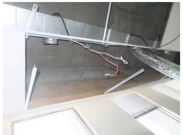
(d) 破壞照片 3
