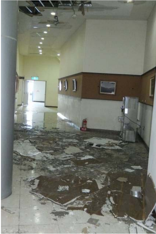
圖7.6 九樓消防管線破損造成積水
