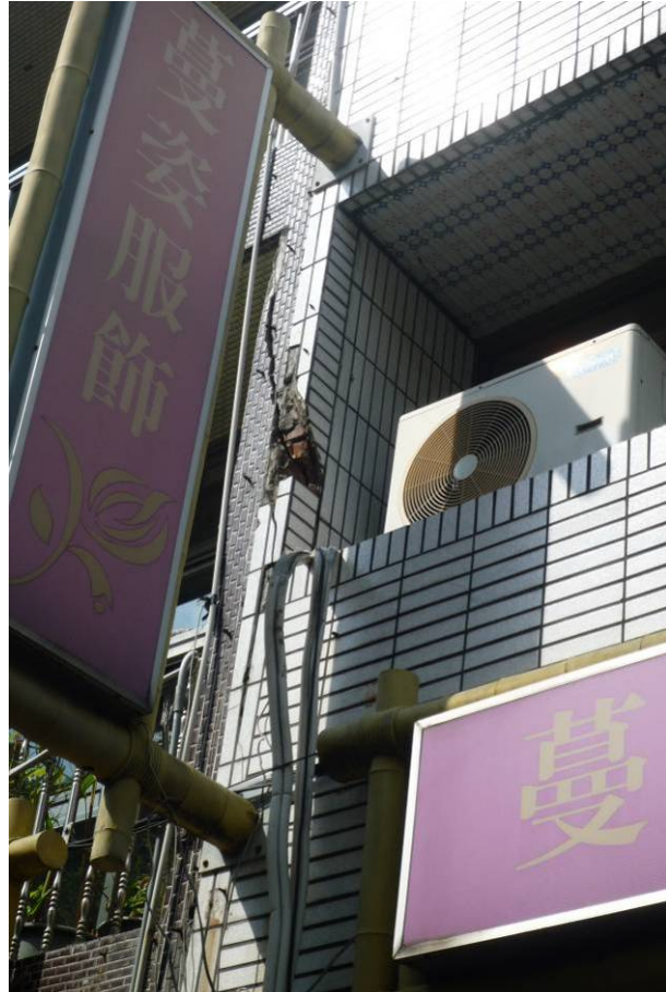
照片5.16 竹山連棟民宅之間的磚牆產生剪力破壞
