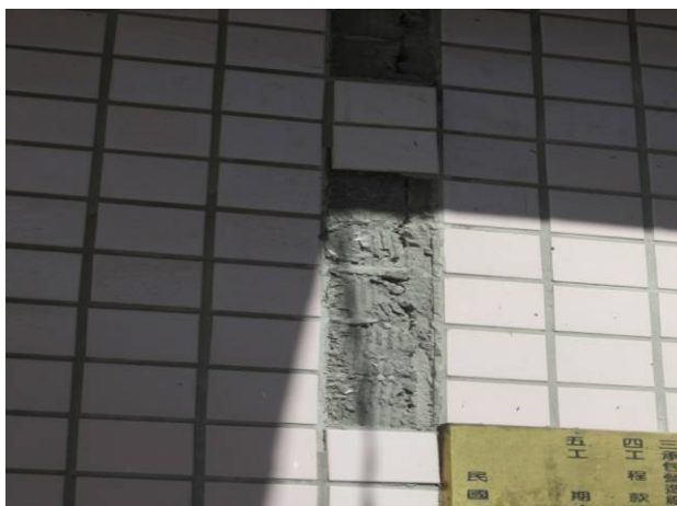
(a) 體育館女廁外牆磁磚掉落
