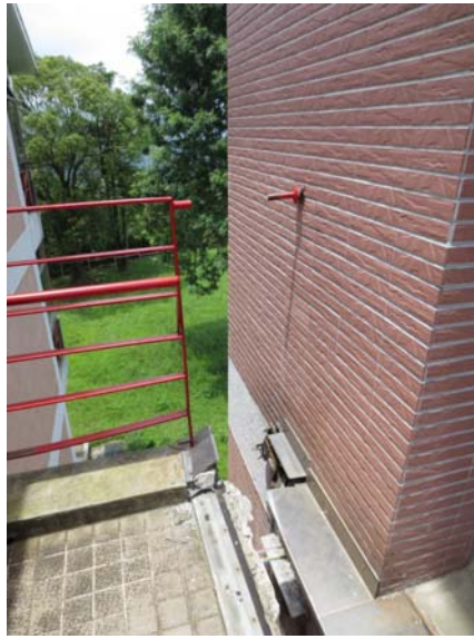
圖 6.6 鐘樓與求真樓間伸縮縫脫離
