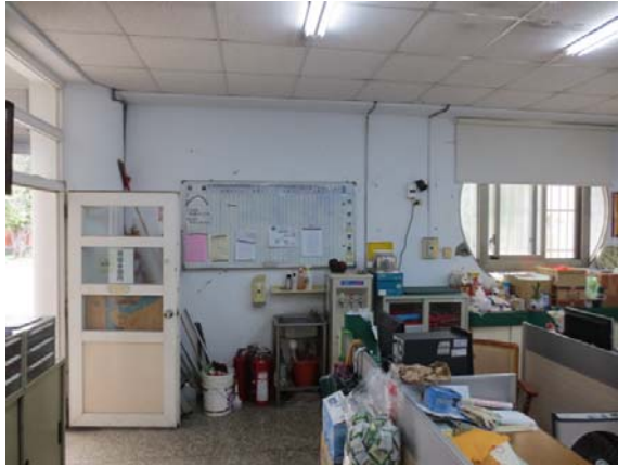
圖 6.69 樹人館總務處磚牆出現輕微剪力裂縫
