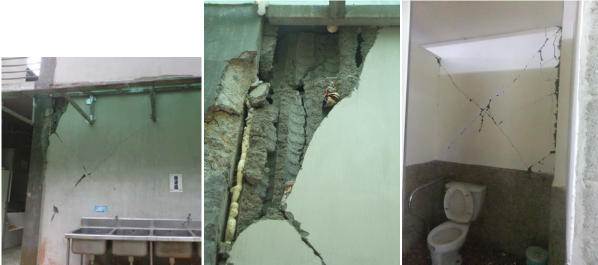
圖 6.39 一樓女廁輕隔間牆裂損
