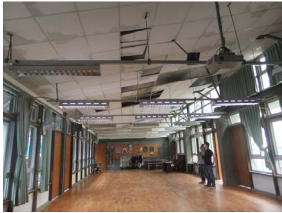
圖 6.40 二樓綜合教室天花板受損
