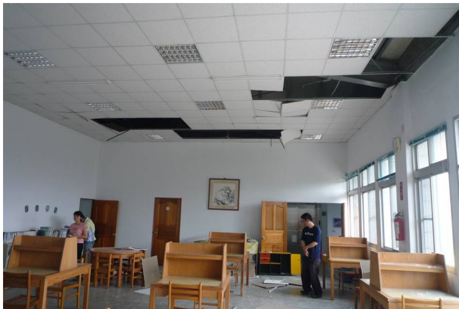
照片5.39 三樓天花板大面積掉落
