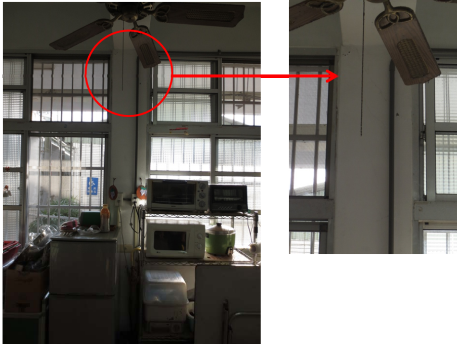
圖 6.25 專科教室柱頂出現輕微剪裂縫
