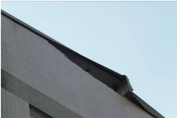
圖7.24 東側磚砌山牆頂部毀損
