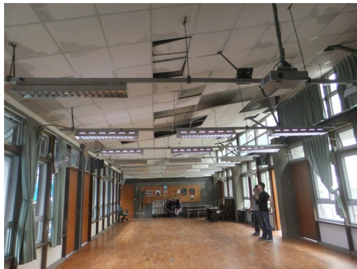
圖7.48 二樓綜合教室天花板受損
