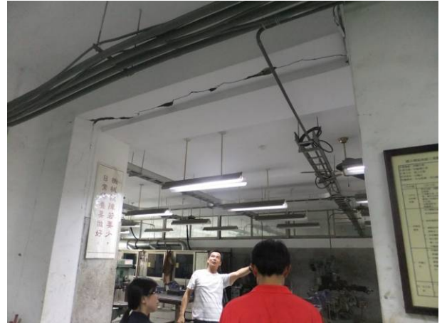
(d) 破壞照片 4
