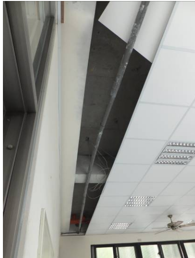
圖7.56 學生宿舍一樓大廳天花板系統之矽酸鈣板板材掉落
