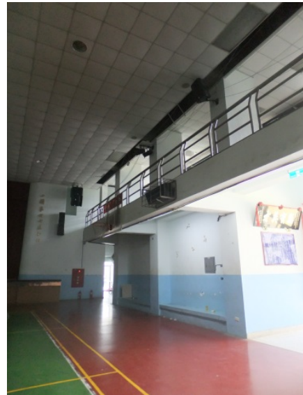
(c)破壞照片 3
