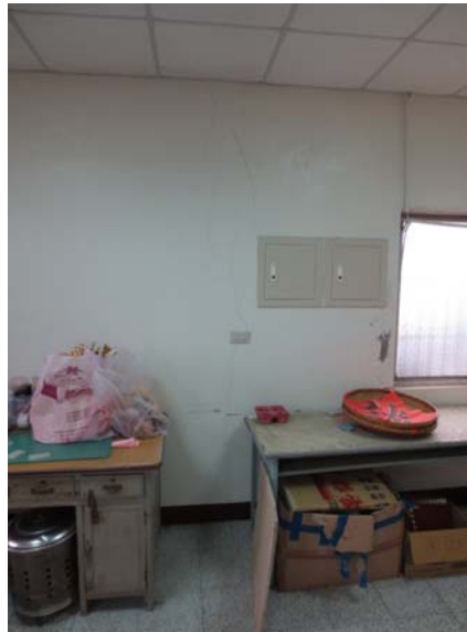
圖 6.75 牆體與鄰棟建築柱體間交界面開裂
