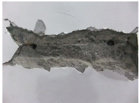
(b)粉刷層剝落處放大照片
