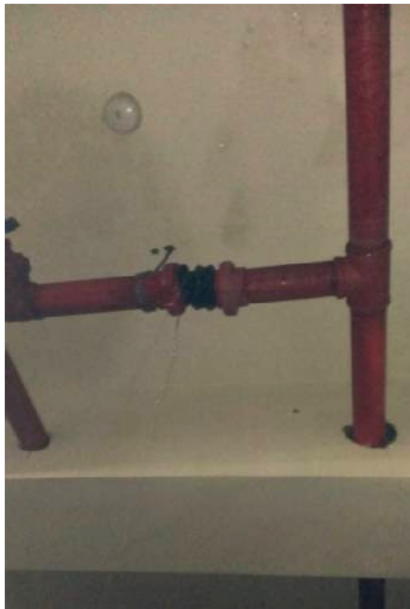
(a) 接頭破損狀況 (校方提供之照片)
