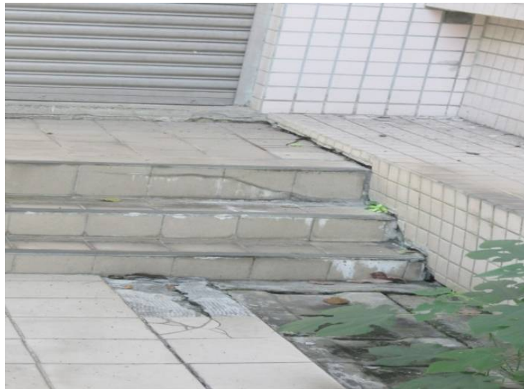
圖7.40 體育館外樓梯地面下陷(校方提供)
