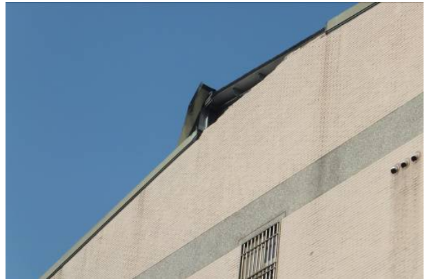
圖7.25 西側磚砌山牆頂部毀損
