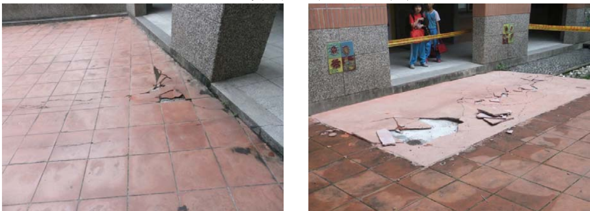
圖 6.63 至善樓與至美樓間地面磁磚擠壓破裂
