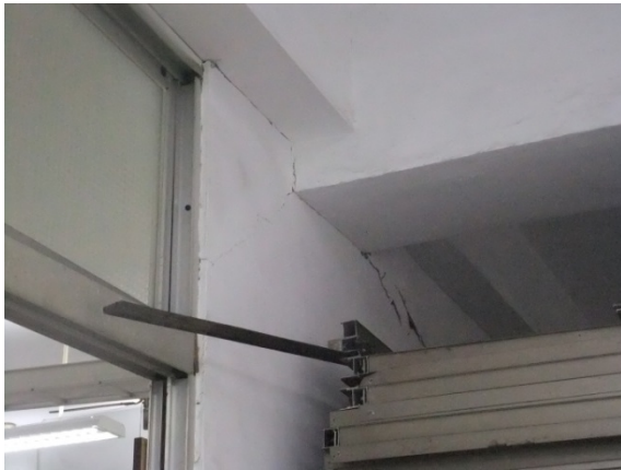
(c)破壞照片 3
