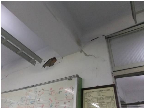
(a) 破壞照片 1
