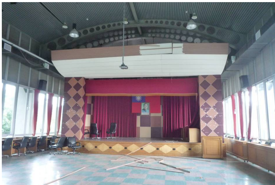
照片5.53 四樓屋頂裝飾材掉落(焊接點斷裂造成)
