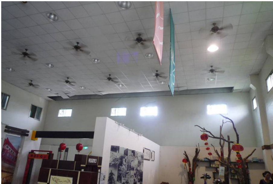
照片5.42 鹿谷鄉觀光服務所天花板部份掉落
