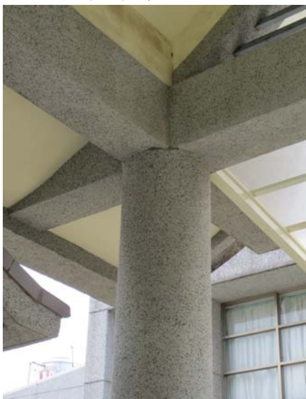
圖 6.12 柱頂粉刷層開裂
