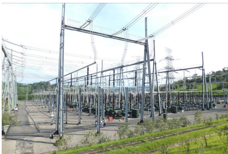
圖7.15 中寮超高壓開閉所
