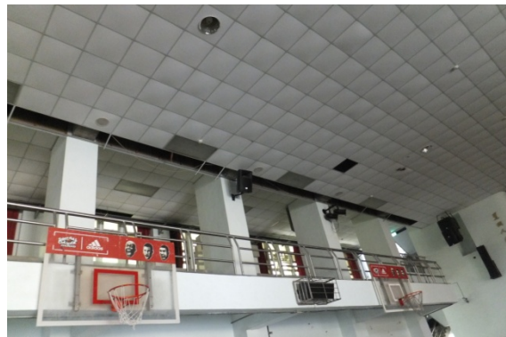
(a)破壞照片 1
