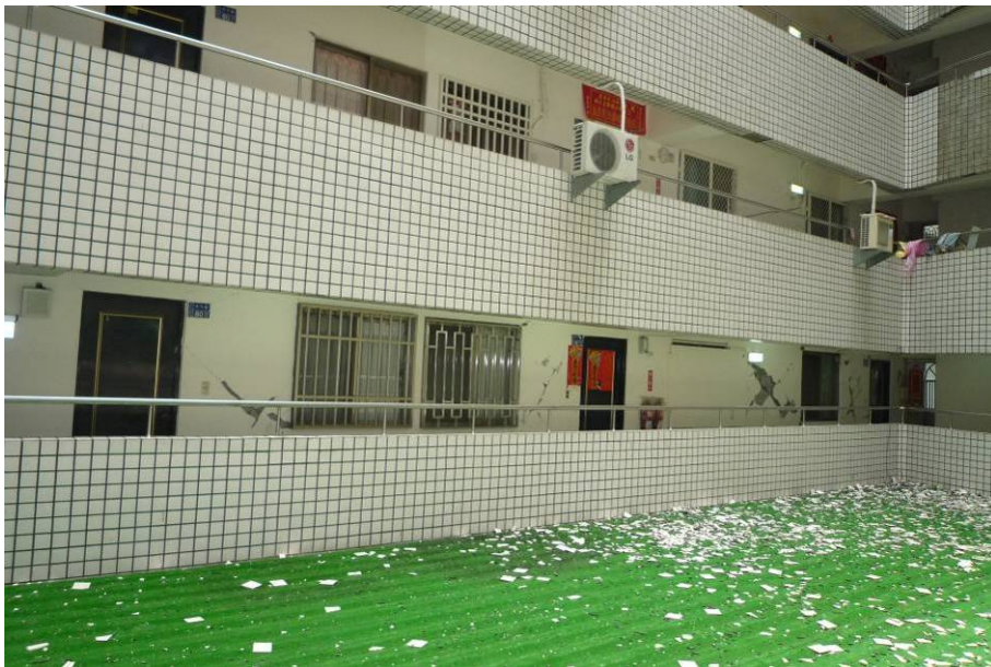
照片 5.9 斗六住商 1 大樓 5 樓後側住家的隔間牆產生剪力裂縫
