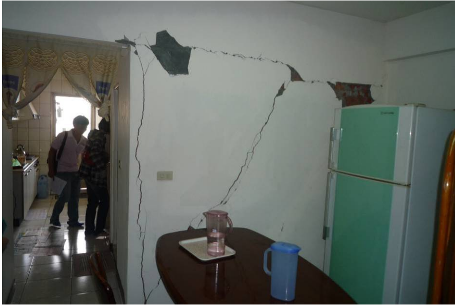
照片 5.10 斗六住商 1 大樓 5 樓後側住家內的隔間磚牆產生剪力裂縫
