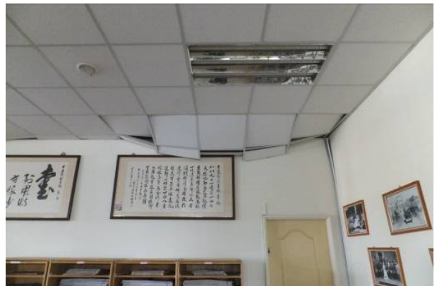
圖7.27 三樓天花板掉落
