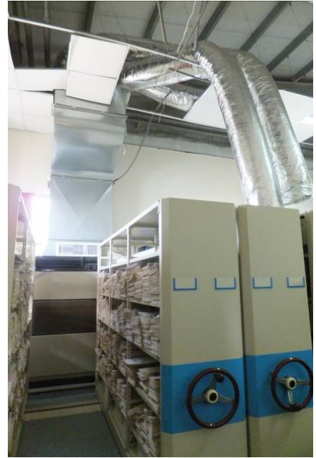
圖7.29 檔案室天花板掉落
