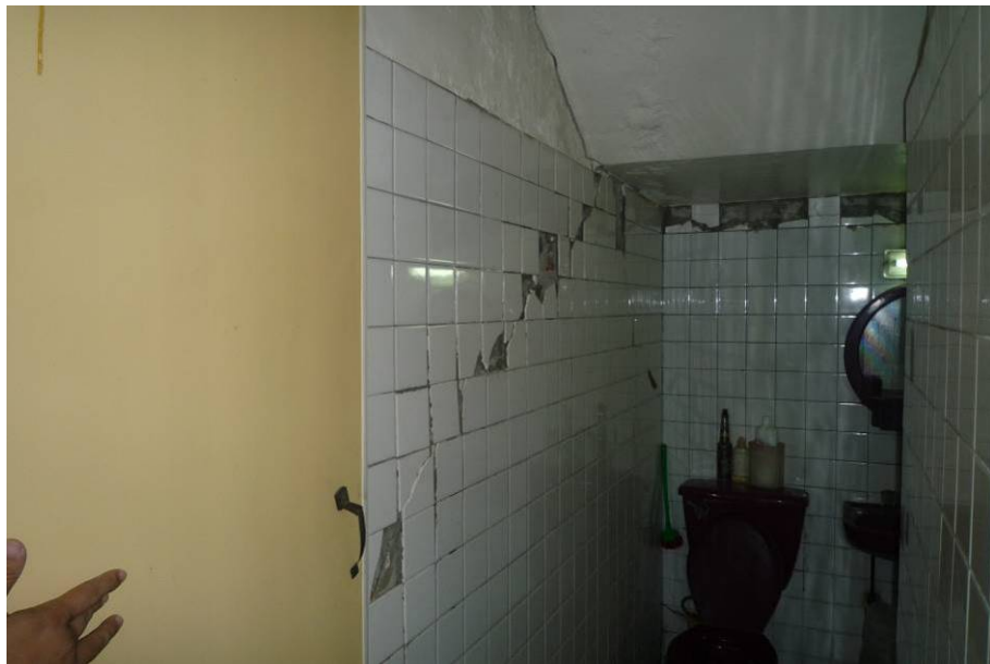
照片5.18 樓梯間兩側的隔間牆產生剪力破壞的裂縫
