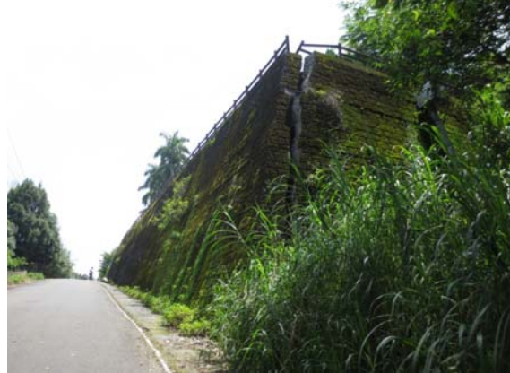
圖 6.3 道路旁擋土牆開裂並造成邊坡滑動
