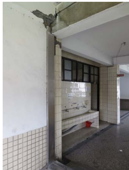
圖 6.72 志學樓與樂群樓三樓相鄰處因碰撞造成梁體混凝土剝落
