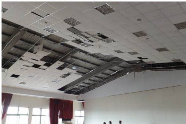
圖7.26 五樓禮堂天花板掉落
