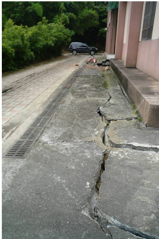
照片5.45 鹿谷鄉銘恩堂基礎周圍路面發生嚴重裂縫
