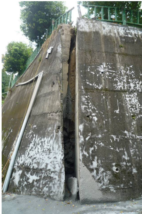
照片5.48 擋土牆之間連結處產生嚴重的滑動大裂縫
