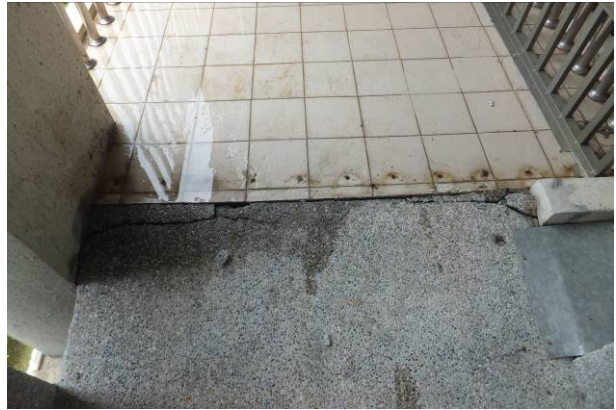
圖7.55 學生宿舍隔離縫處鋪面破損
