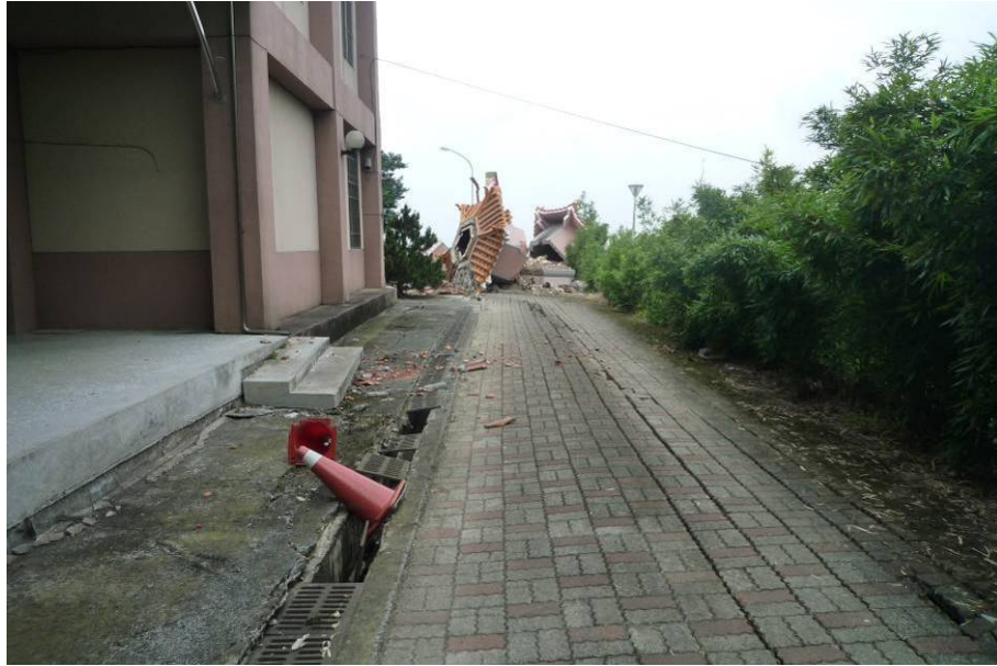
照片5.44 鹿谷鄉銘恩堂基礎周圍路面隆起
