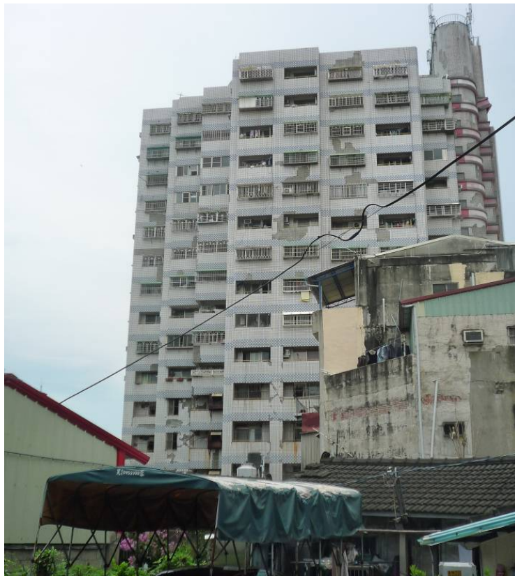
照片 5.11 斗六住商 1 大樓背面損壞情況
