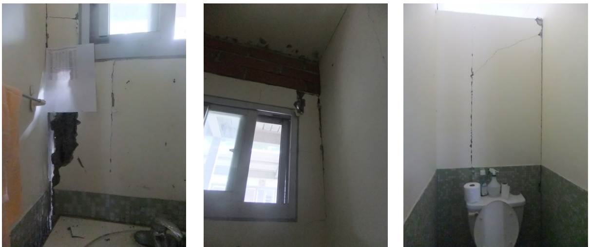
圖7.45 一樓保健中心廁所隔間牆穿透性裂損剝落
