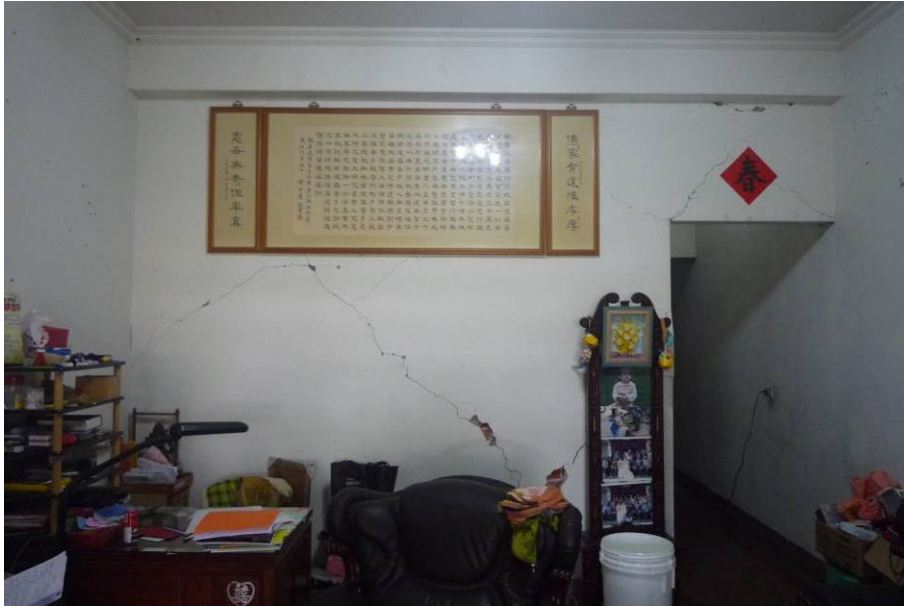
照片5.29 與街道平行的隔間牆出現剪力裂縫
