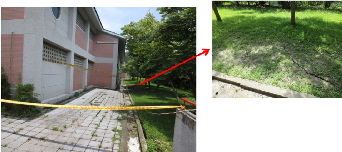
圖 6.7 勤學樓背面邊坡滑動
