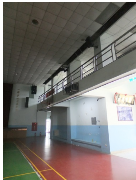
(c) 破壞照片 3
