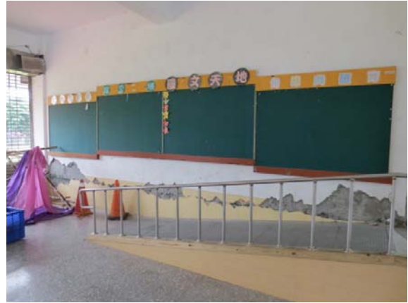
圖 6.70 樂群樓穿堂磚牆與地梁交界面出現滑動
