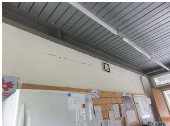
圖 6.38 一樓導師室與穿堂間牆面水平裂縫
