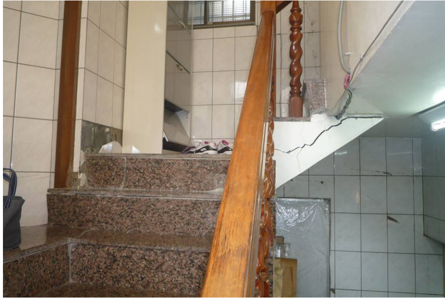
照片5.22 樓梯轉折處產生局部的破壞
