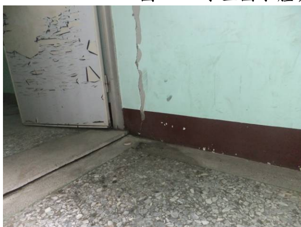
(a) 埋牆水管受損致使主控室滲水
