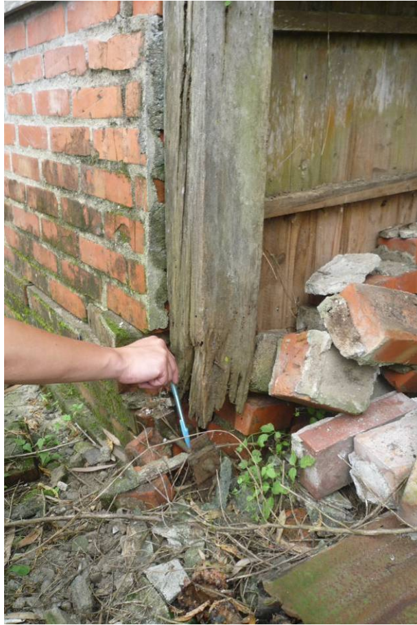
照片5.32 竹山山區木造民宅的柱子部份已腐敗
