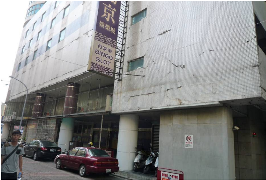
照片5.5 斗六商辦建物側面外牆產生剪力裂縫
