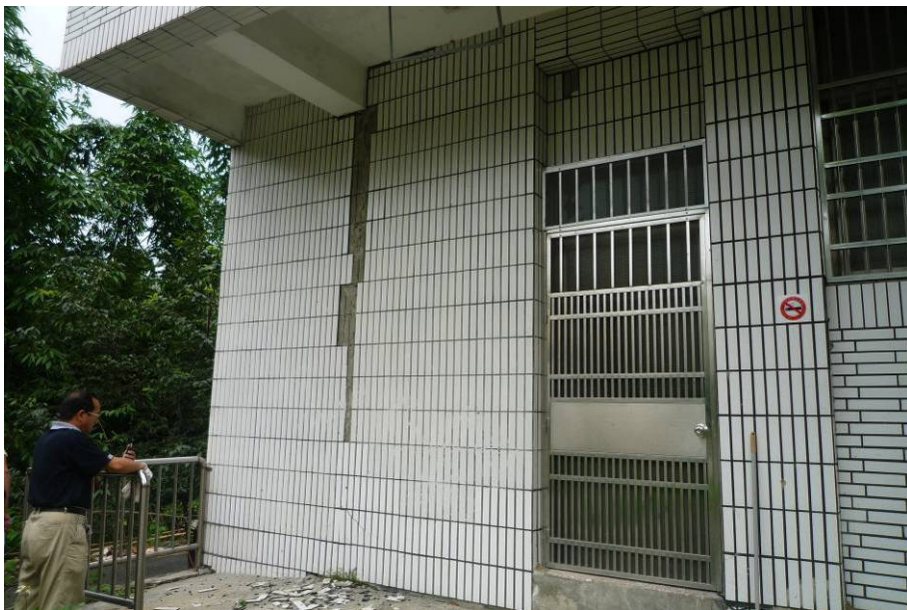
照片5.37 一樓外牆產生局部破壞
