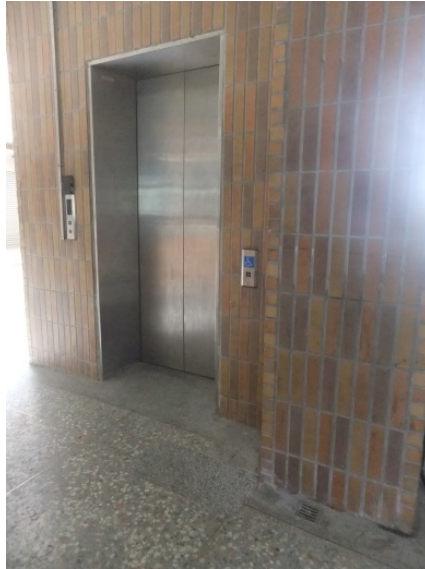
圖 6.56 綜合工廠大樓電梯受損
