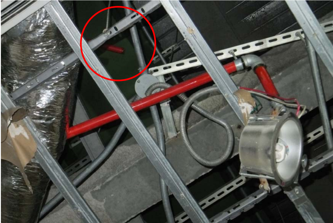
圖7.4 九樓 A 處消防管線斷裂
