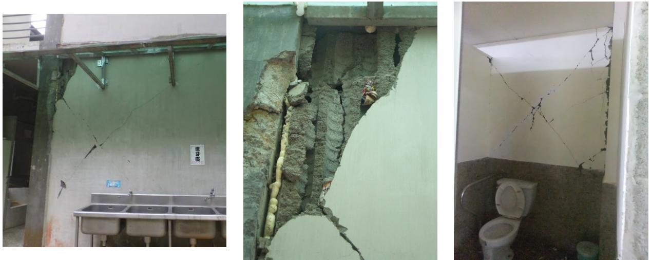
圖7.47 一樓女廁鋼骨柱間與隔間牆穿透性裂損剝落
