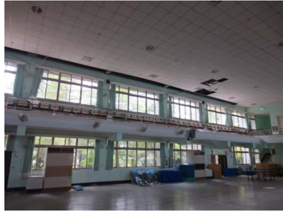
圖 6.11 活動中心輕鋼架天花板掉落
