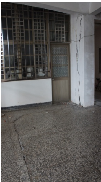
(a)柱體因碰撞產生裂縫 (0327 南投地震)
