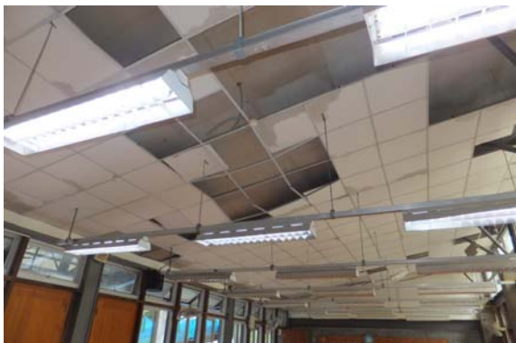
(a)位於中間區域之天花板骨架破壞
