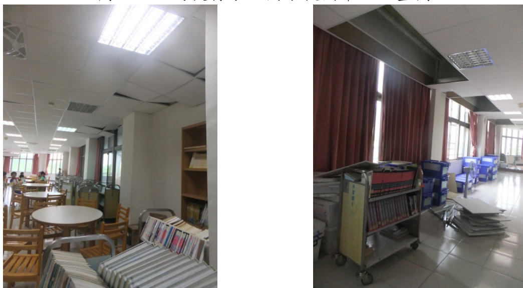
圖 6.33 教學大樓二樓圖書室天花板邊緣受損
