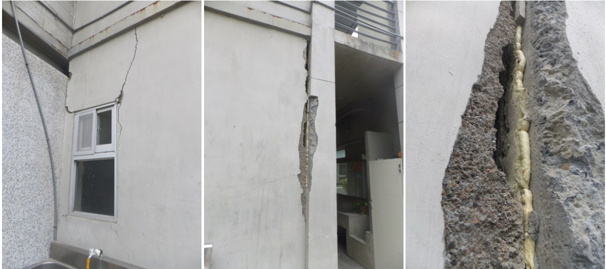
圖 6.36 一樓男廁輕隔間牆裂損
