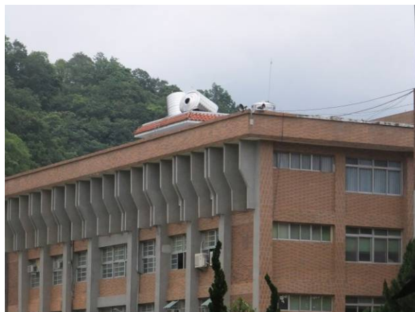
(b) 圖書館大樓水塔受損待置換
