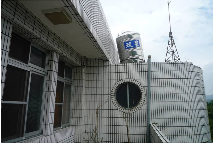
照片5.40 頂樓水塔傾斜，水管管線受損
