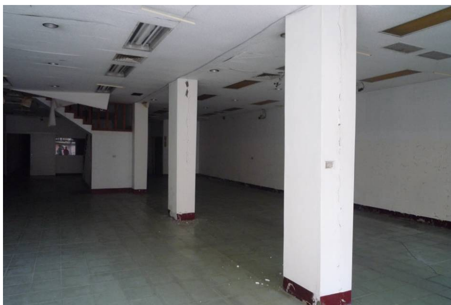
照片5.25 竹山民宅1產生明顯的兩柱界面裂縫（兩棟相鄰的牆面已拆除）
