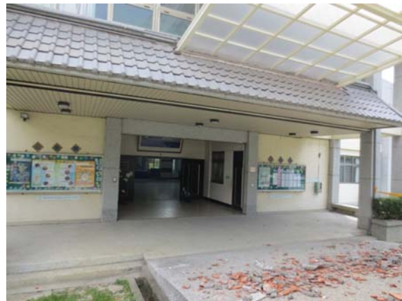
圖 6.13 遮光罩脫離後撞及屋瓦，造成大量屋瓦掉落
