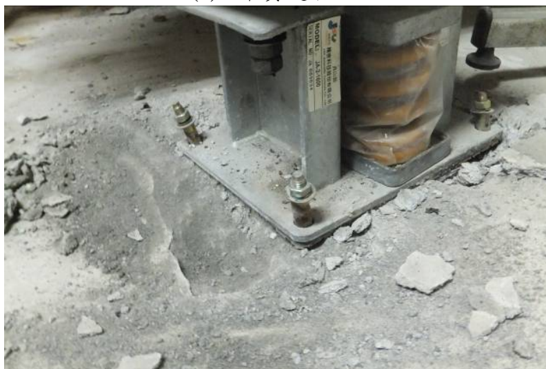
(b) 彈簧避振器之錨錠處受損
