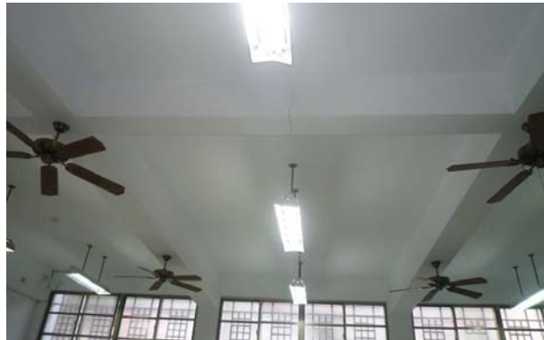
圖 6.30 美術教室中間位置的梁產生明顯撓曲裂縫
