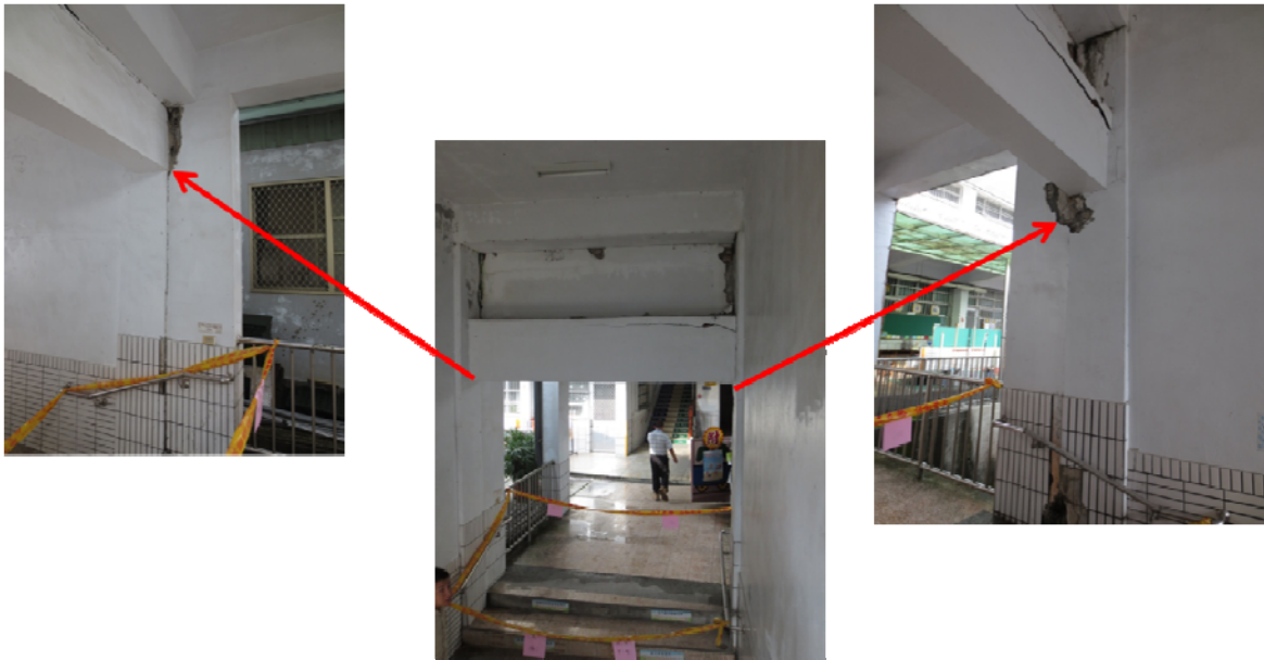
圖 6.24 行政大樓與專科教室之樓梯間碰撞造成混凝土剝落
