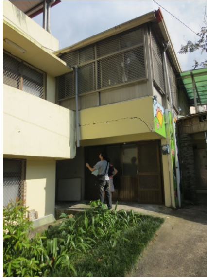
圖 6.17 宿舍之間相互碰撞，造成女兒牆牆體受損
