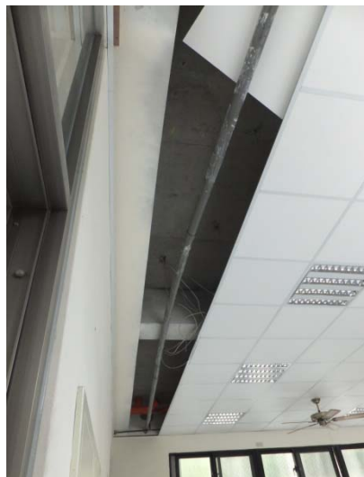
圖 6.48 學生宿舍一樓大廳天花板系統之矽酸鈣板板材掉落
