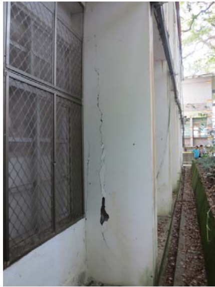
圖 6.16 普通教室 A 背面側併柱交界位置出現開裂
