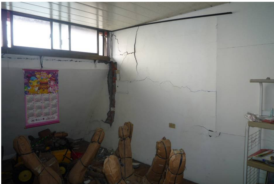
照片5.56 四樓受鄰棟碰撞導致磚牆及屋瓦造型斜牆受損
