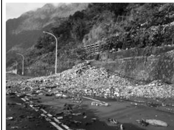
照片 23. 蘇花公路 155K+750 於 0512 豪雨事件零星坍方影響車道
