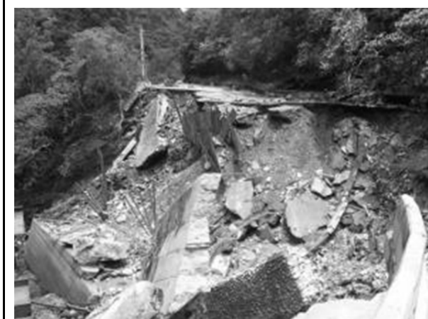
照片 17. 蘇花公路 147K+000 於蘇拉颱風期間道路阻斷情形
