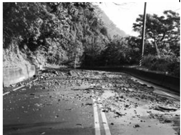
照片 22. 蘇花公路 151K+200 於 0512 豪雨事件零星坍方影響車道
