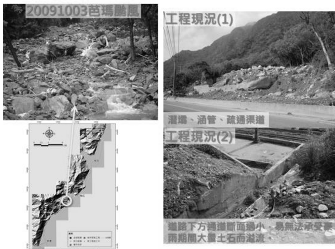
圖 4.31 蘇花公路樁號 168K+000 土石流災害狀況與復建工程現況圖
