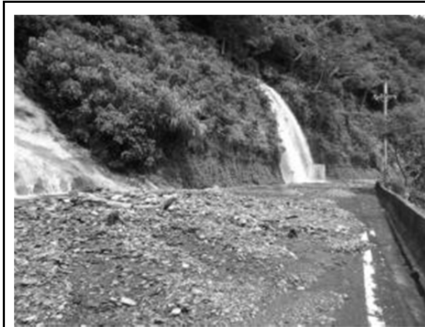
照片 19. 蘇花公路 149K+300 於 0512 豪雨事件零星坍方影響車道
