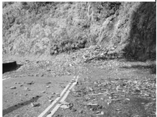
照片 20. 蘇花公路 149K+750 於 0512 豪雨事件零星坍方影響車道
