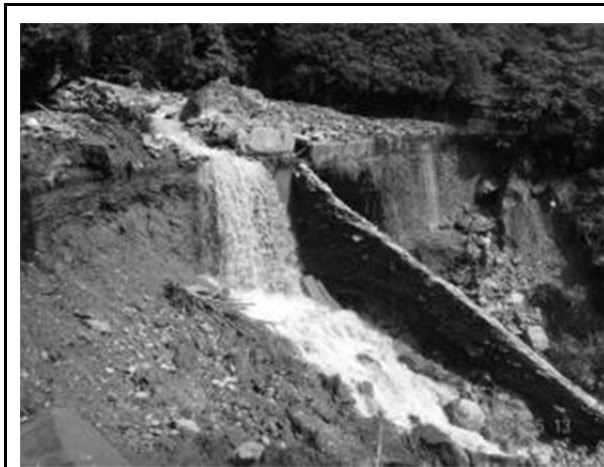
照片 13. 蘇花公路 144K+750 於 0512 豪雨事件道路阻斷情形
