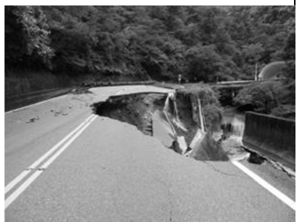
照片 18. 蘇花公路 147K+050 於 0512 豪雨事件道路阻斷情形
