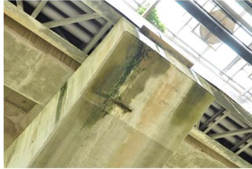
• P6、P7、P9帽樑下端鋼筋外露
