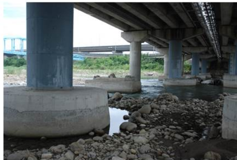
• 多數橋墩基礎沖刷掏空 • 墩柱皆以鋼板包覆
