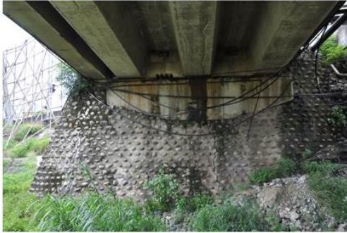
• A2引道護坡裂縫
