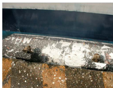
圖 4.35 基隆港東 2 號碼頭防舷材劣化異狀照片
