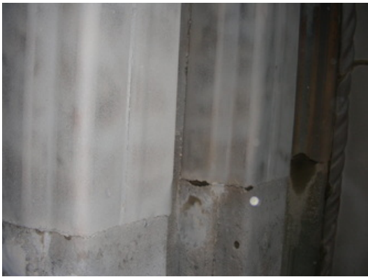
圖 3.6 典型鋼板樁碼頭構造局部破損穿孔現象
