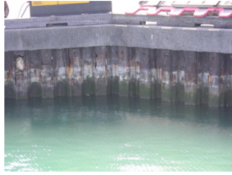
圖 3.5 典型鋼板樁碼頭構造銹損破壞現象
