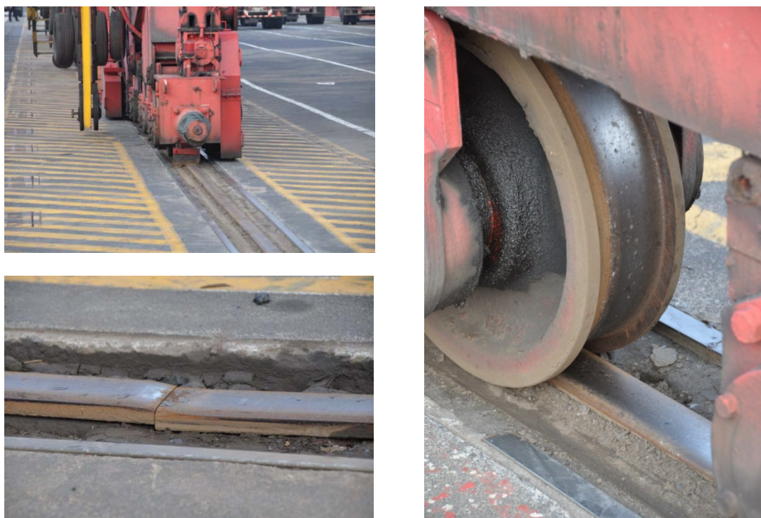
圖 2.9 起重機軌道損壞鋼軌接縫高差照片
