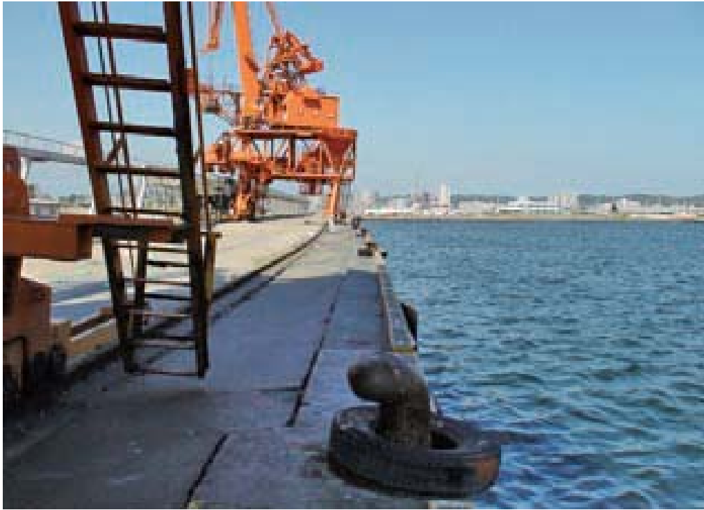
圖 1.1 東日本大地震(碼頭的岸壁法線向海側位移)
