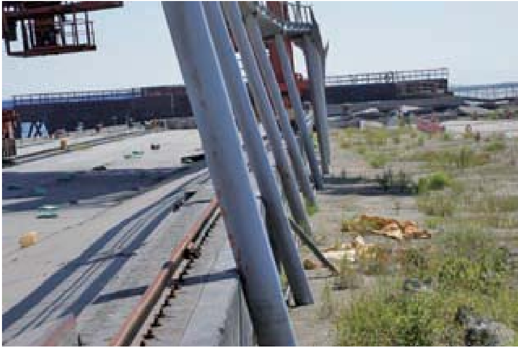
圖 1.3 東日本大地震(後側地盤差異沉陷)
