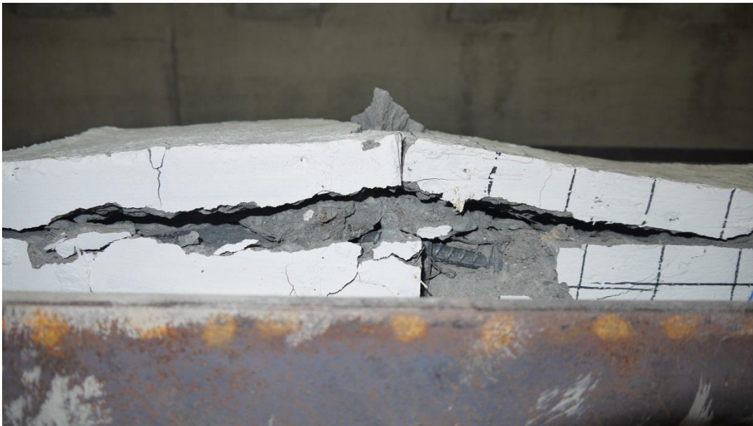
圖 4-31 梁 RB3 之頂部與柱 2Cd 2 柱頂混凝土隆起情形
