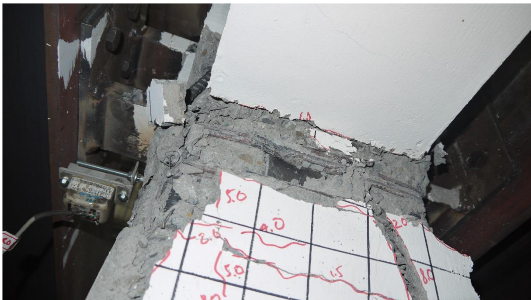
圖 4-28 柱編號 2Cd_1 之柱頂主筋與鋼骨翼板產生挫屈之情形
