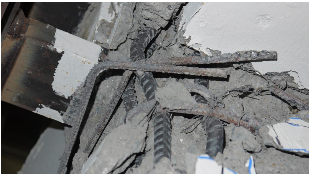
圖 4-32 柱編號 2Cs 1 主筋於位移比 6% 時之挫屈情形
