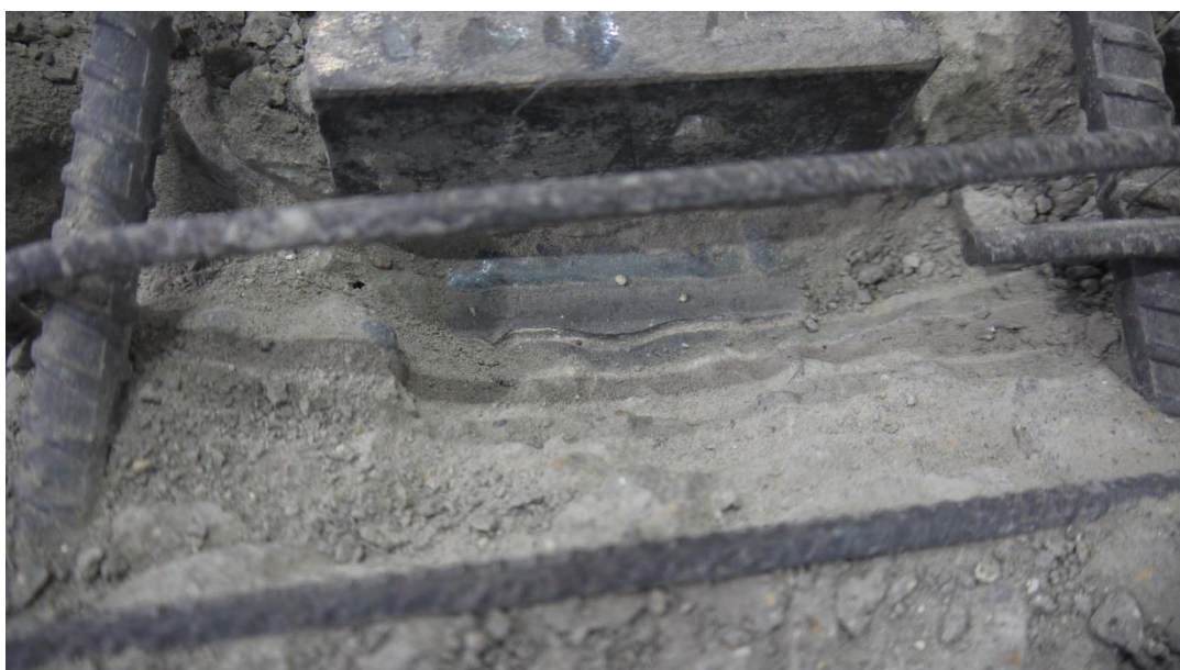
圖 4-38 梁 RB3 頂部鋼骨翼板於於實驗中止後之破壞情形
