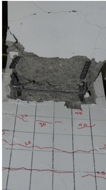
圖 4-24 梁編號 RB3 於位移比 8% 時梁底主筋產生斷裂之情形
