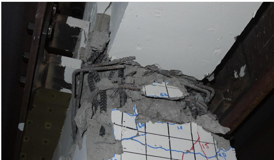
圖 4-35 柱編號 2C_{s1} 柱頂主筋多處發生斷裂之情形
