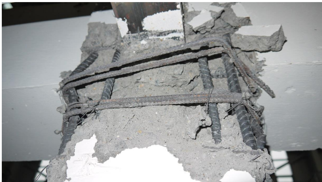
圖 4-62 2C_{s1} 塑鉸區圍束箍筋之斷裂情況
