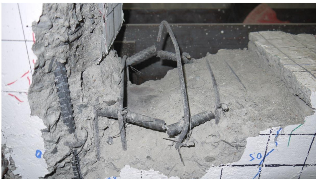
圖 4-41 梁 2B3 頂部鋼主筋於實驗中止後之破壞情形
