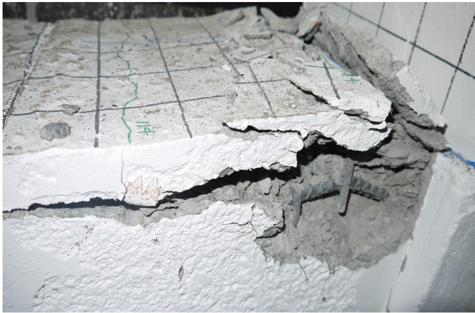
圖 4- 21 梁編號 2B3 於位移比 6% 時梁頂壓力筋產生挫屈之情形
