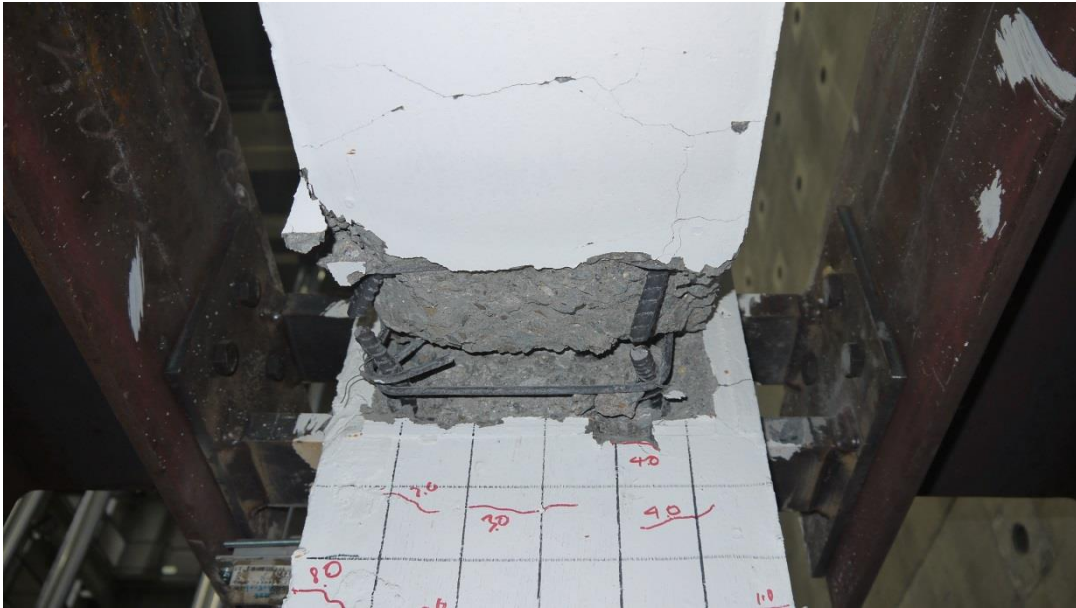
圖 4-29 梁 RB3 與柱 2Cd 2 交界面之分離情形
