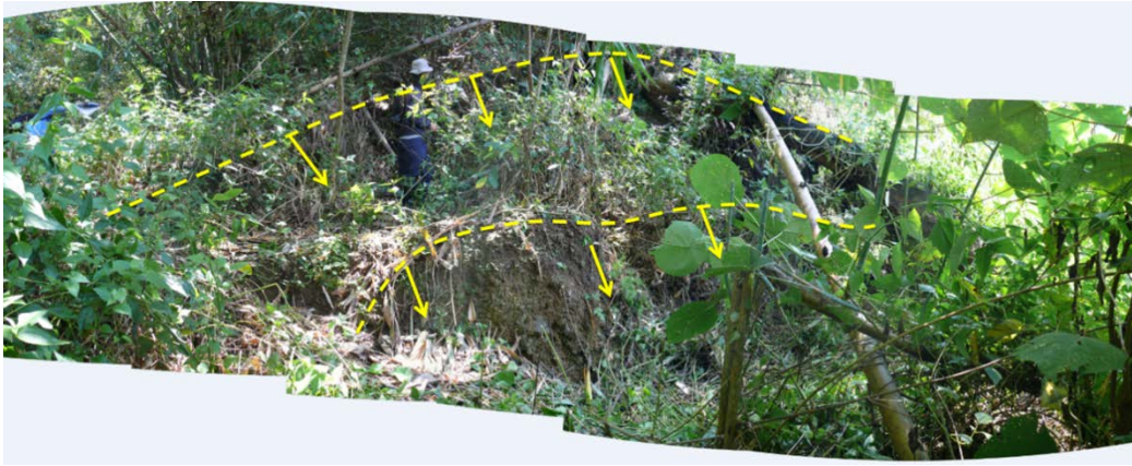
圖 6.40 點位 SP3 崩塌現況
