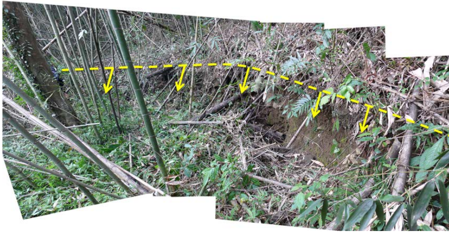
圖 6.45 點位 SP6 潛在崩塌現況
