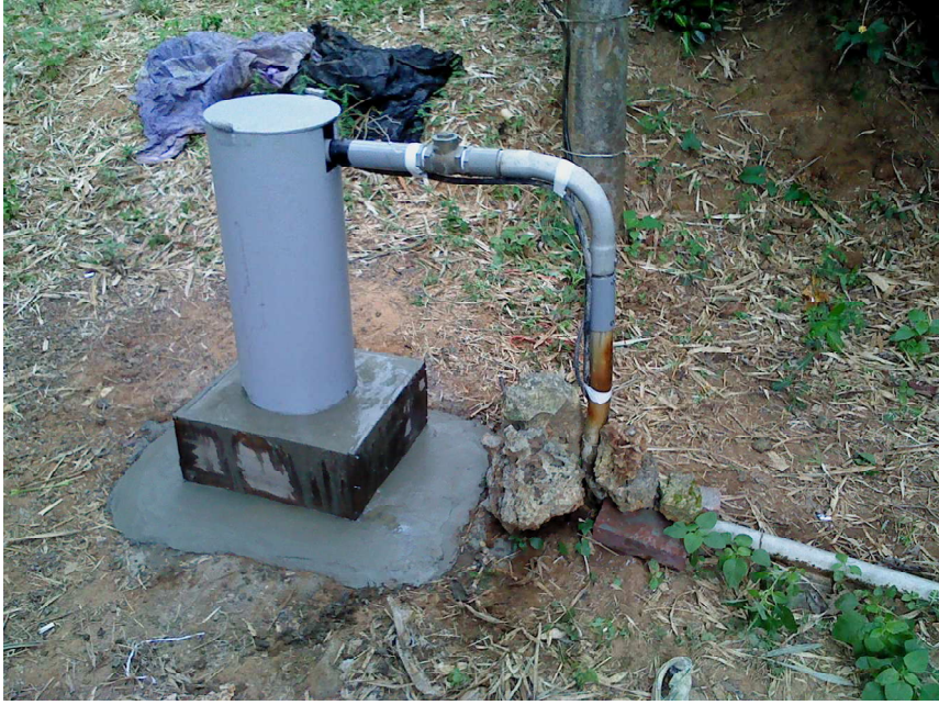
圖 7-26：墾丁公園社頂站放置自動水位紀錄儀之水井。
