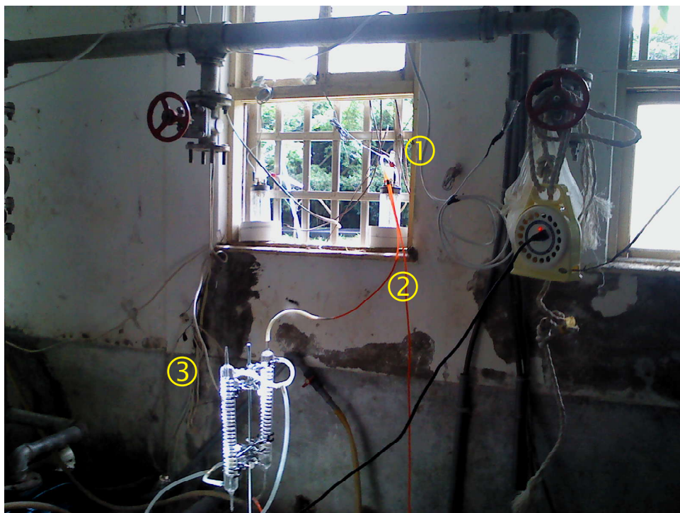
圖 7-24：社頂站建築物內部配置（①：氣水分離器，RAD Aqua；②：氣體管線；③：氣體冷凝裝置）。
