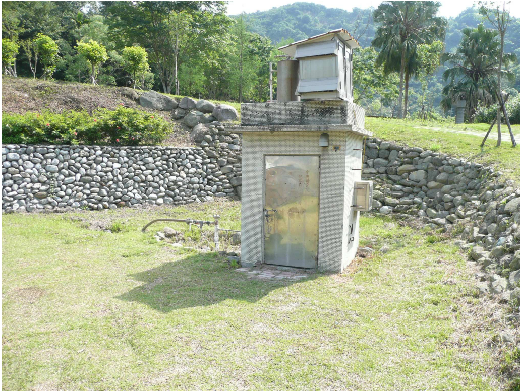
圖 7-16：安通站 500 米自流井及監測站外觀。
