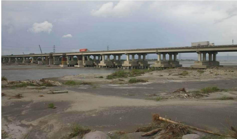
圖 2.10 國道 1 號中沙大橋橋基裸露情形 [6]
