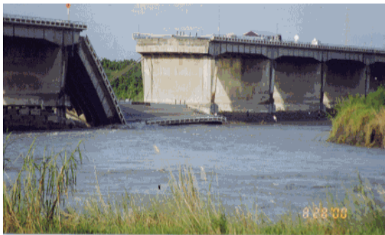
圖 2.6 高屏大橋斷橋事故 [11]
