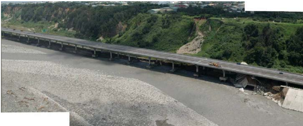
圖 2.12 國道 4 號神岡高架橋基礎裸露情形 [5] (林呈教授空拍，
