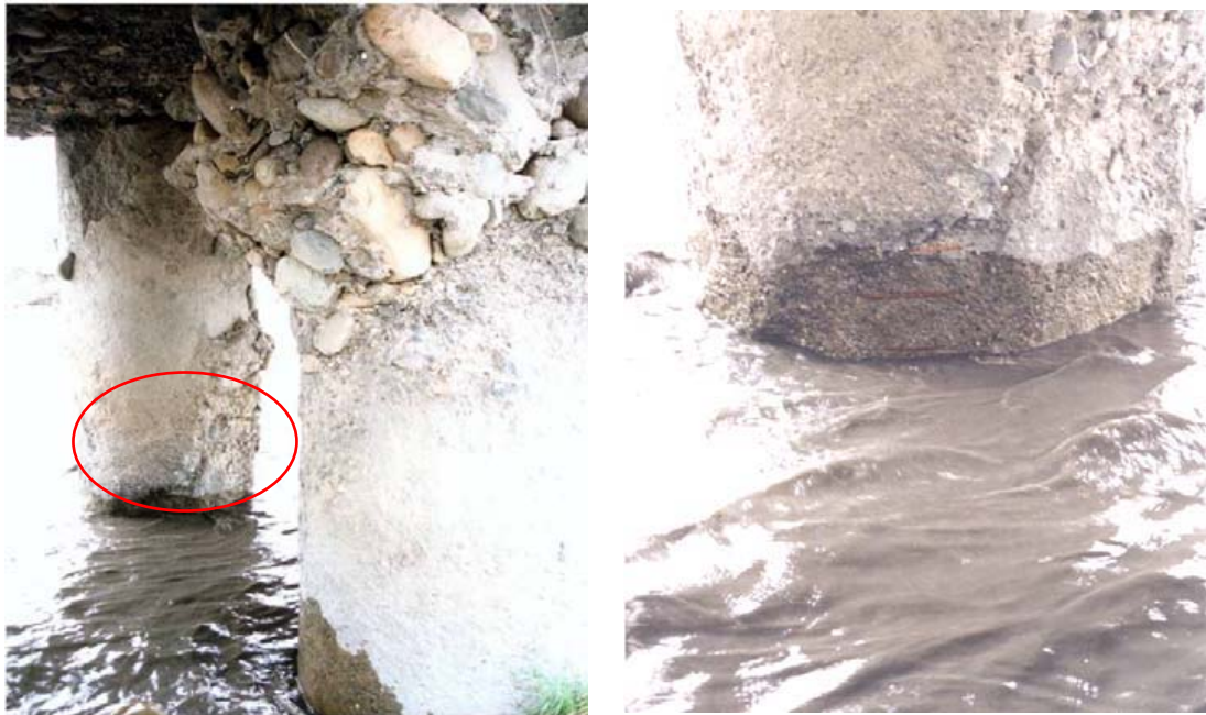
圖 2.9 中二高濁水溪橋基樁受磨蝕鋼筋外露 [4] (2001/08/02 台灣營建研究院)
