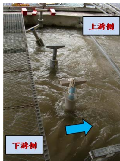
(b) 破壞情形
