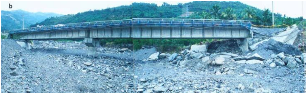
(b)橋址處因束縮沖刷破壞情形
