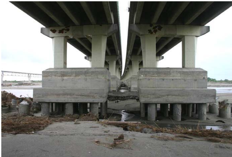
圖 2.11 國道 1 號中沙大橋 P30 橋墩基礎裸露情形 [4] (2004/8/11 台灣營建研究院)
