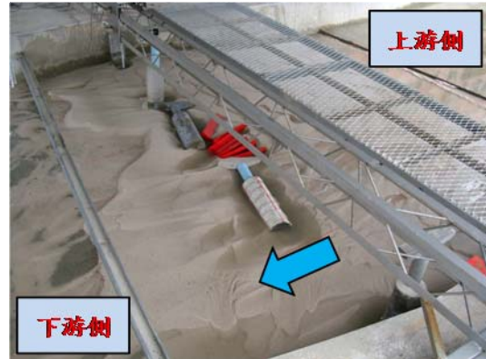
(b) 破壞情形
