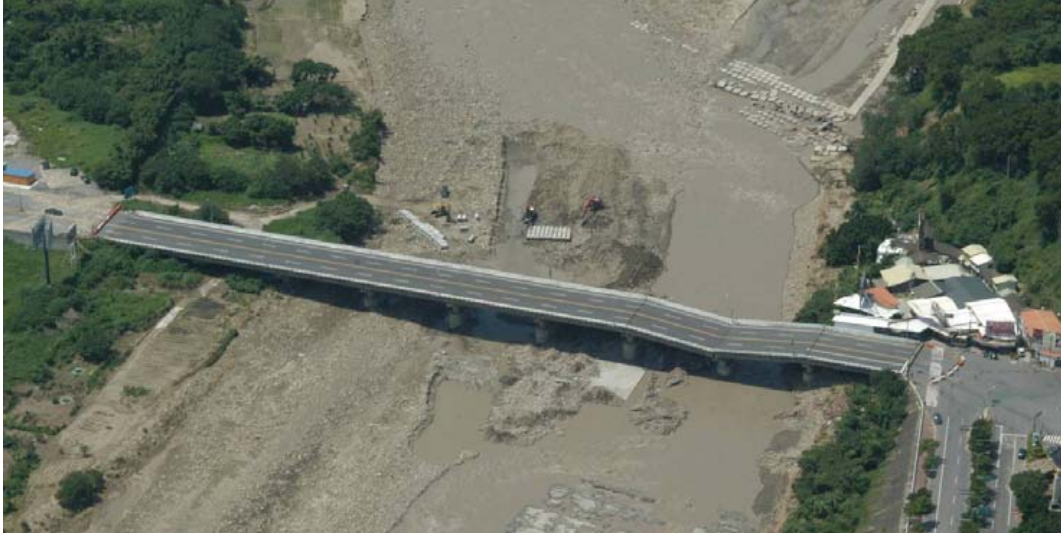
圖 2.13 台 6 線龜山大橋 P2 橋墩下陷 [5] (林呈教授空拍, 2004/8/30)
