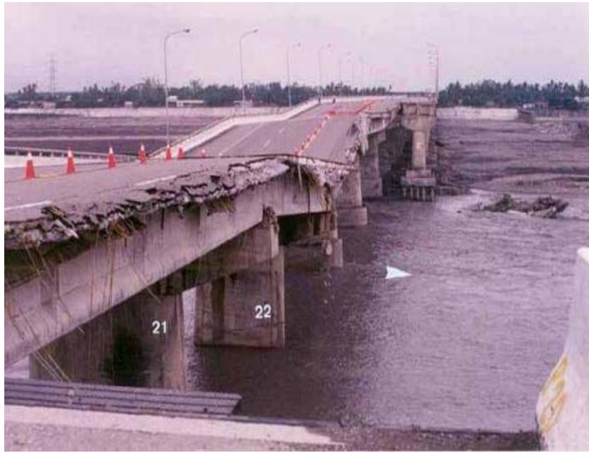
圖 2.1 台 3 線里港大橋橋梁倒塌斷裂 [5] (林呈，1996/08/06)
