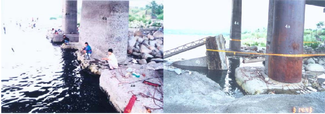
圖 2.3 台 3 線東豐大橋 P4b 橋墩倒塌 [4]
