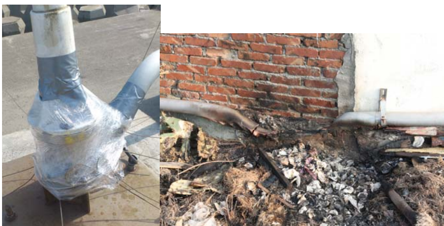
圖 1-1.5 左為大潭發射天線有保鮮膜方式包覆避免遭受碎浪衝擊，右為北堤站接收天線因火災導致線路斷裂的情況。
