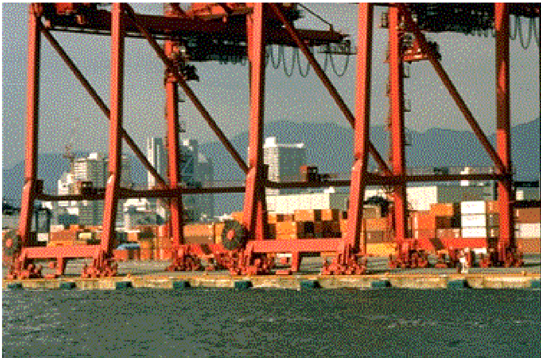
圖 1.2 神戶地震沉箱側移引起起重機柱腳降伏彎曲
