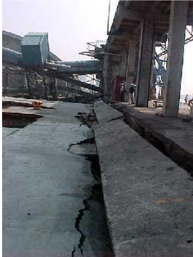
圖 1.3 集集地震臺中港沉箱碼頭沉陷
