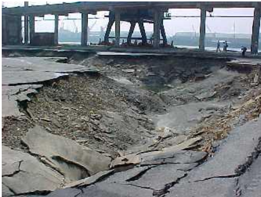
圖 1.4 集集地震臺中港土壤液化引起破壞
