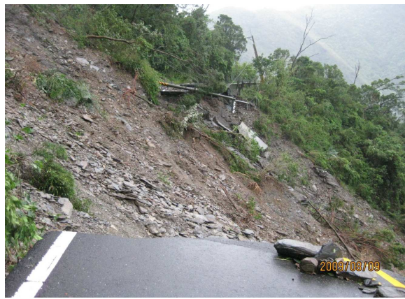
圖 4.39 台 24 線 28K+300 於莫拉克 颱風期間道路阻斷情形
