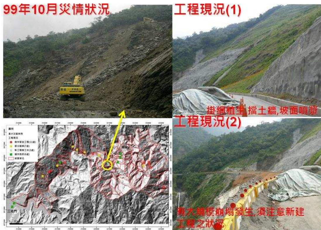
圖 4.82 樁號 35K+400 岩體滑動災害狀況與復建工程現況圖
