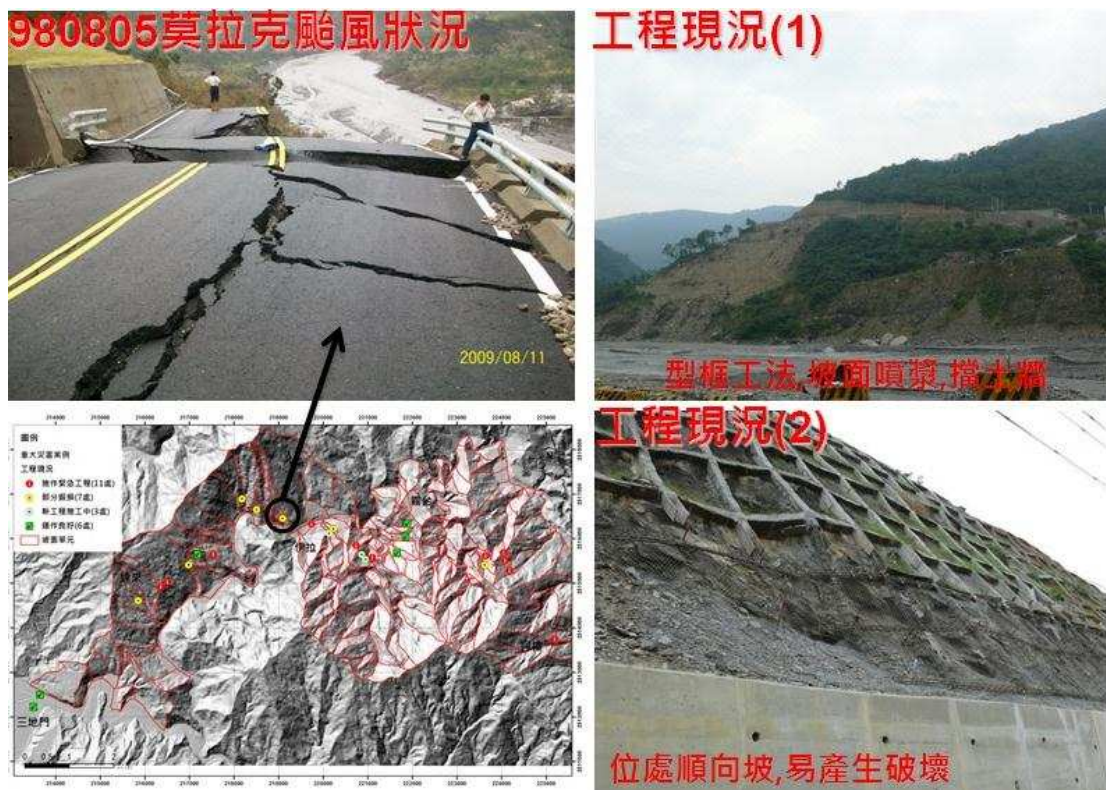
圖 4.80 樁號 31K+500 岩體滑動災害狀況與復建工程現況圖
