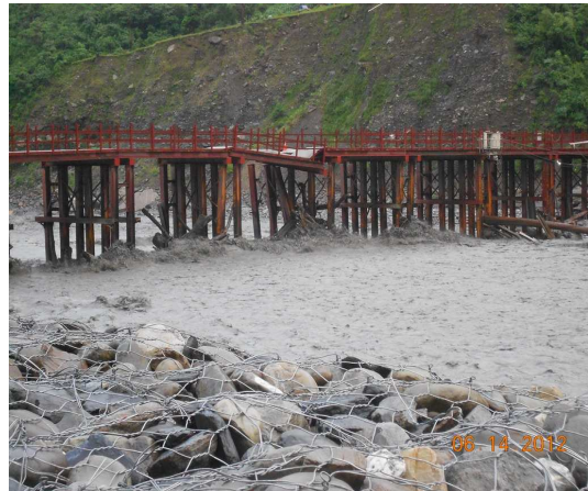
圖 4.56 台 24 線 32K+890 於 0609 豪雨事件便道毀損情形
