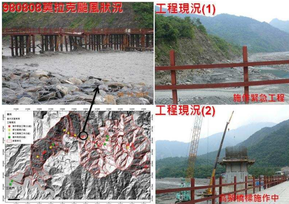
圖 4.81 樁號 32K+890 岩體滑動災害狀況與復建工程現況圖
