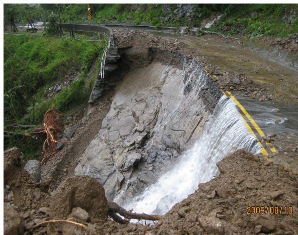
圖 4.37 台 24 線 26K+000 於莫拉克 颱風期間道路阻斷情形
