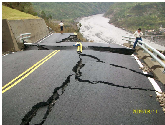
圖 4.43 台 24 線 31K+500 於莫拉克 颱風期間道路阻斷情形
