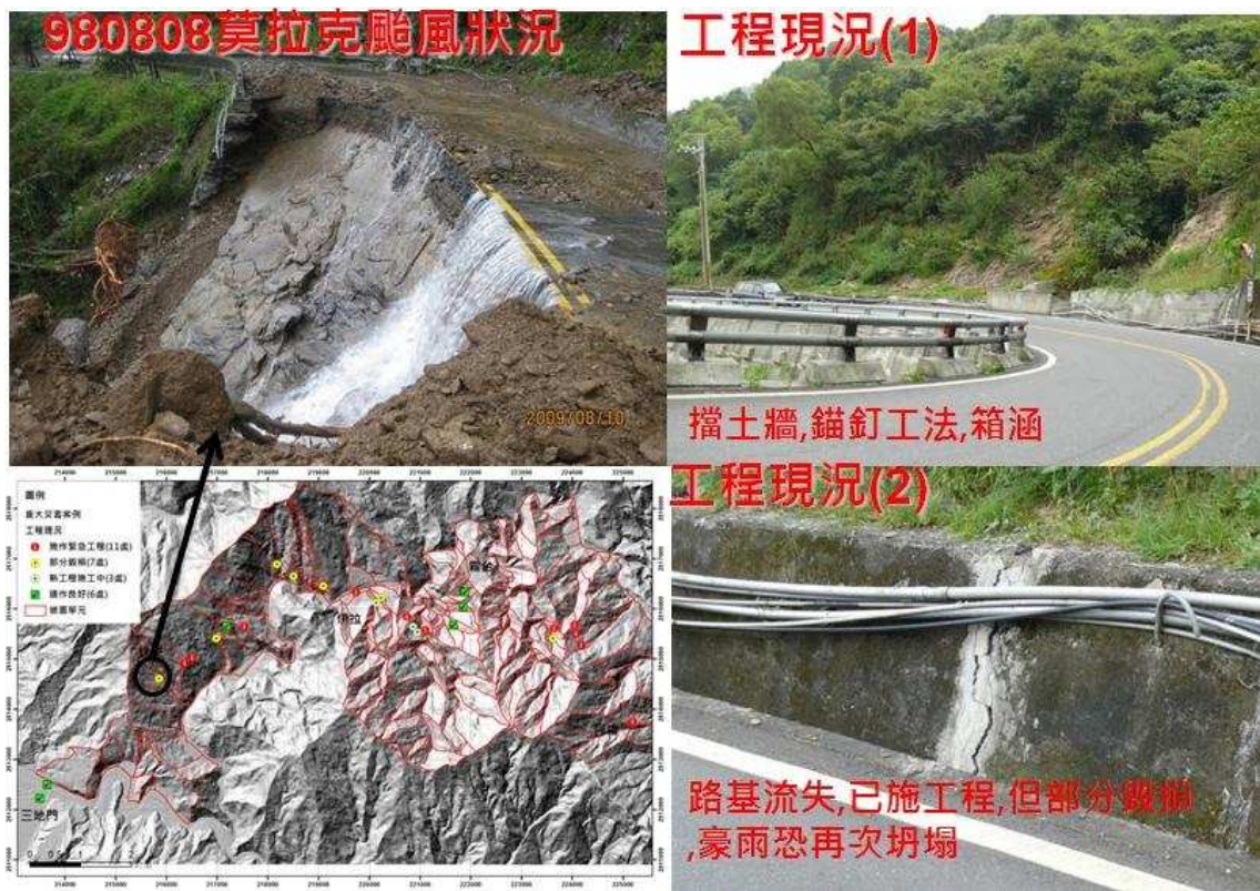
圖 4.78 樁號 26K+000 岩體滑動災害狀況與復建工程現況圖
