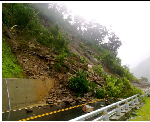
圖 4.42 台 24 線 31K+500 於莫拉 克期間道路阻斷情形
