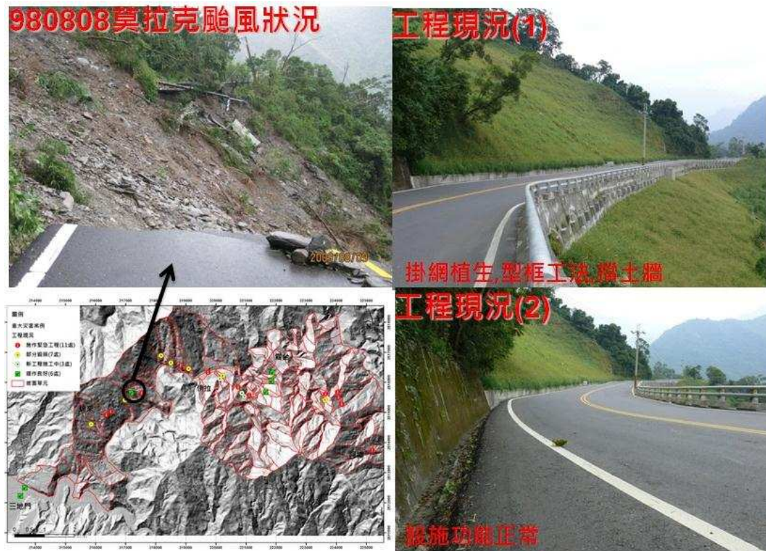
圖 4.79 樁號 28K+300 岩體滑動災害狀況與復建工程現況圖
