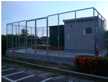
b. 重要機電設備調昇
