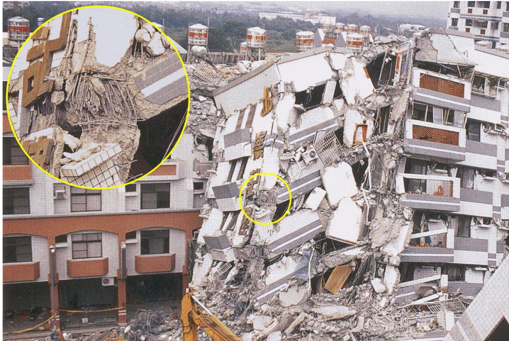
圖 2-3 1999 年地震倒塌的建築物梁柱接頭無箍筋圍束
