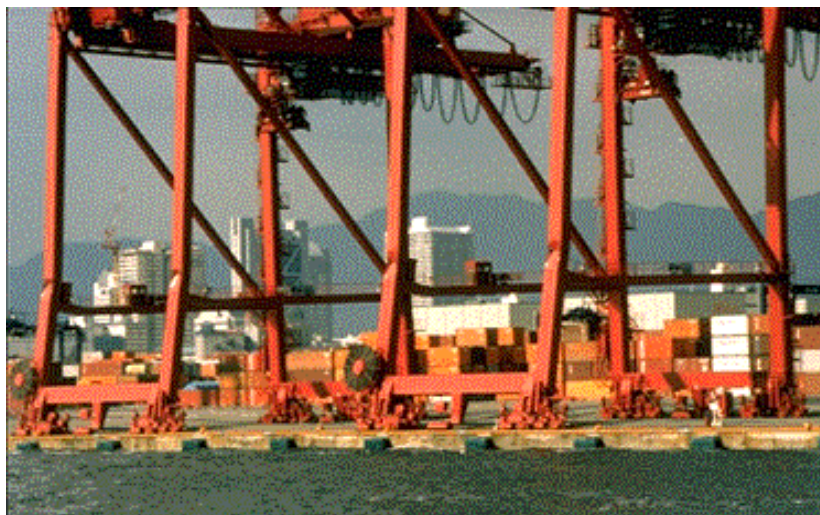
圖 1.2 神戶地震沉箱側移引起起重機柱腳降伏彎曲
