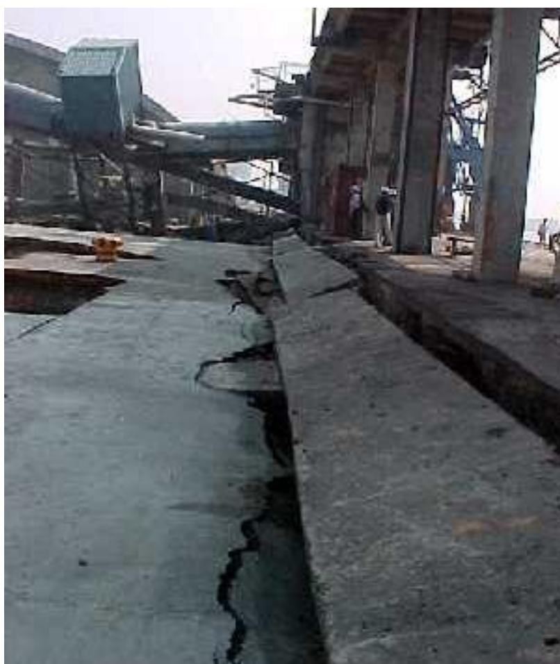
圖 1.3 集集地震臺中港沉箱碼頭沉陷
